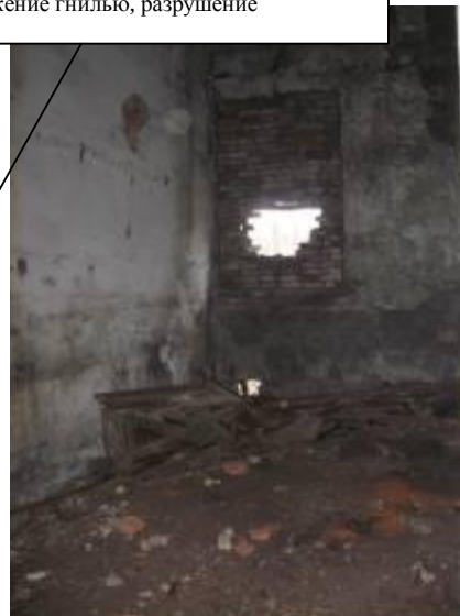
поражение гнилью, разрушение
