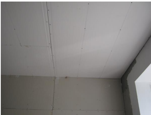
15. Типичное состояние отделки стен и потолка
