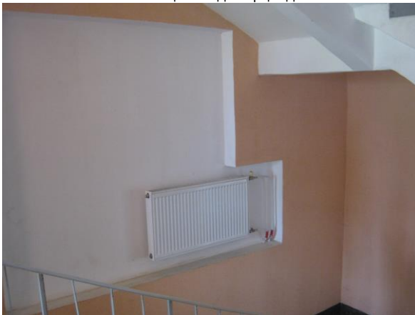
11. Состояние отделки подъезда
