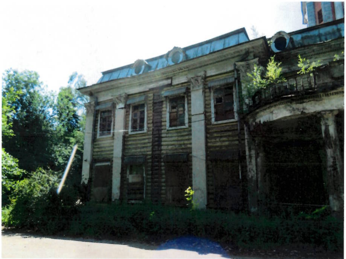
Фото №4. Фрагмент южного фасада. Отсутствие оконных проемов.
