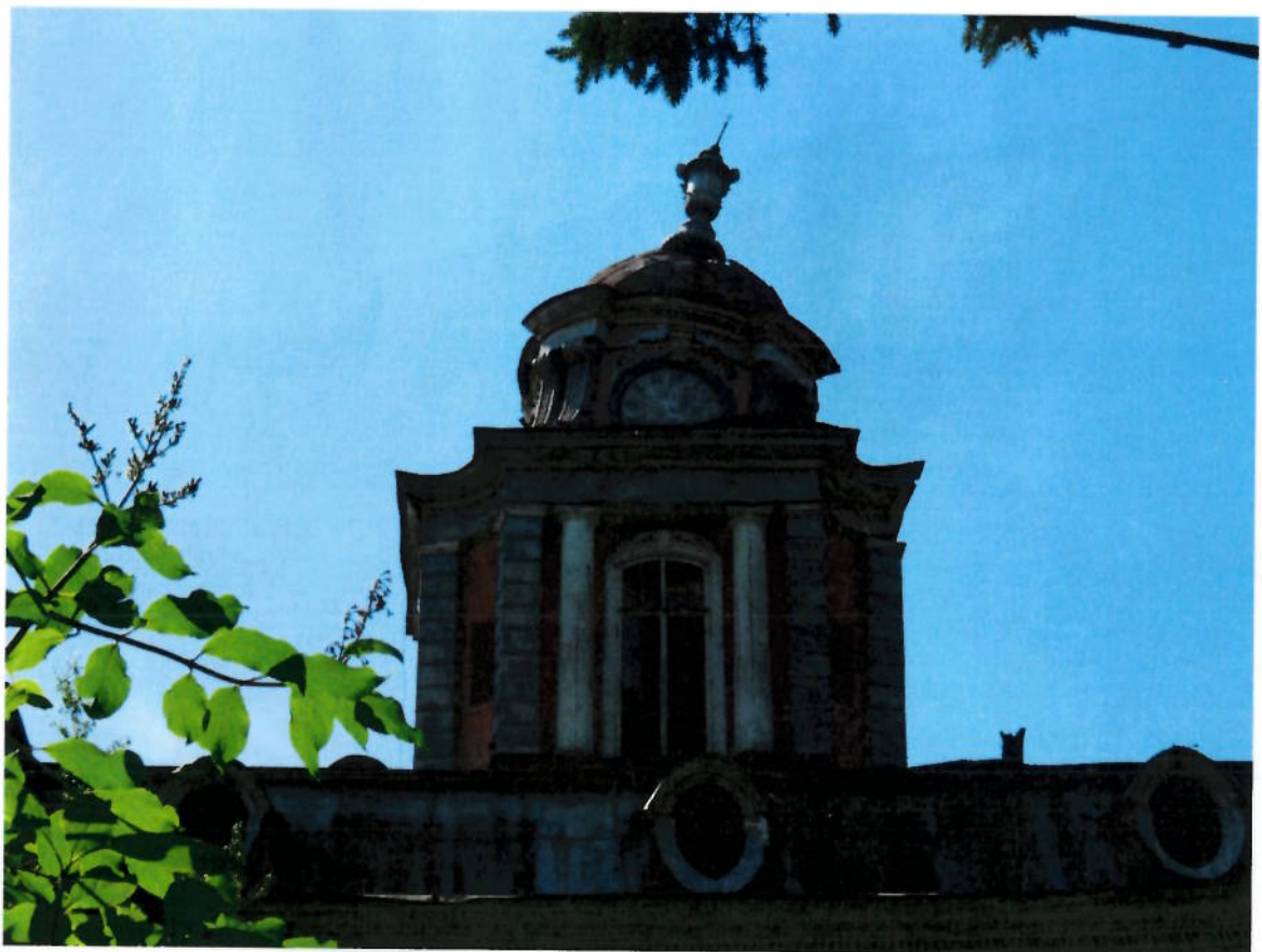
Фото № 2. Часовая башня. Крен.
