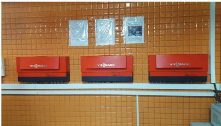
Газовая система отопления Viessmann
