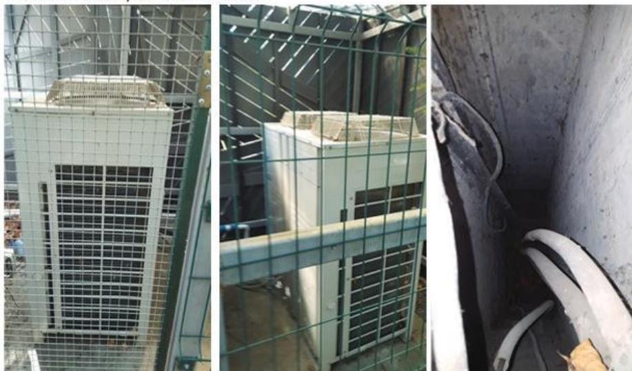
Внешние блоки мульти сплит системы
