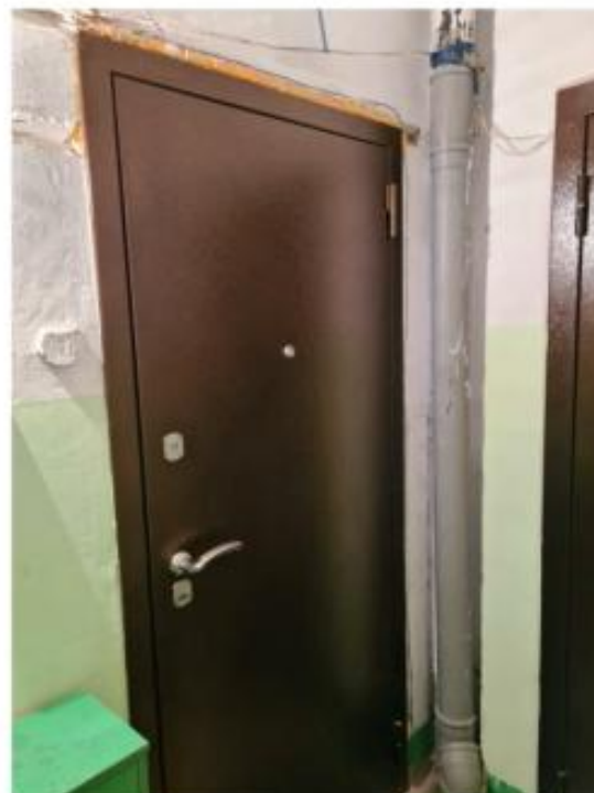
Фото №8. Входная дверь в квартиру. Вид из подъезда. На входной двери отсутствует табличка с номером квартиры.
