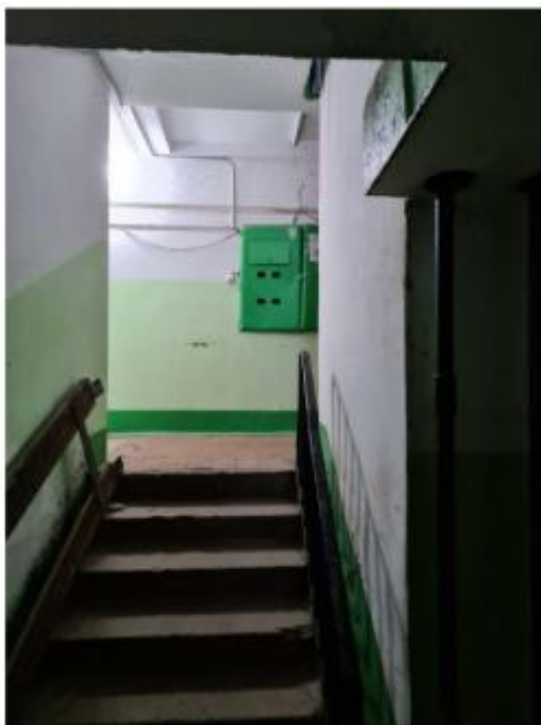
Фото №5. Состояние подъезда.
