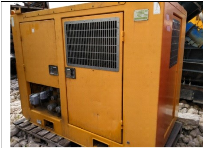
Фото 19. Силовая установка HERRENKNECHT Hitsaggregat 12000306/H- 243, пр-во Германия, №3005 7554
