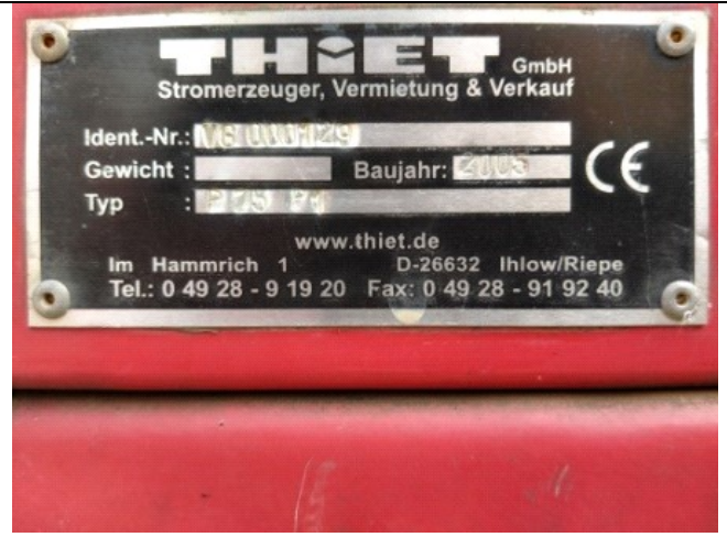
Фото 18. Дизельная электростанция THJET P 75 P1, пр-во Германия, VG 000129
