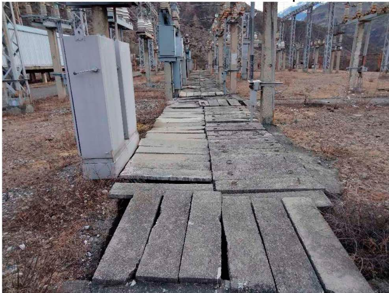
Кабельный канал ПС-110-35/6 кВ ГПП «Ирганай»
