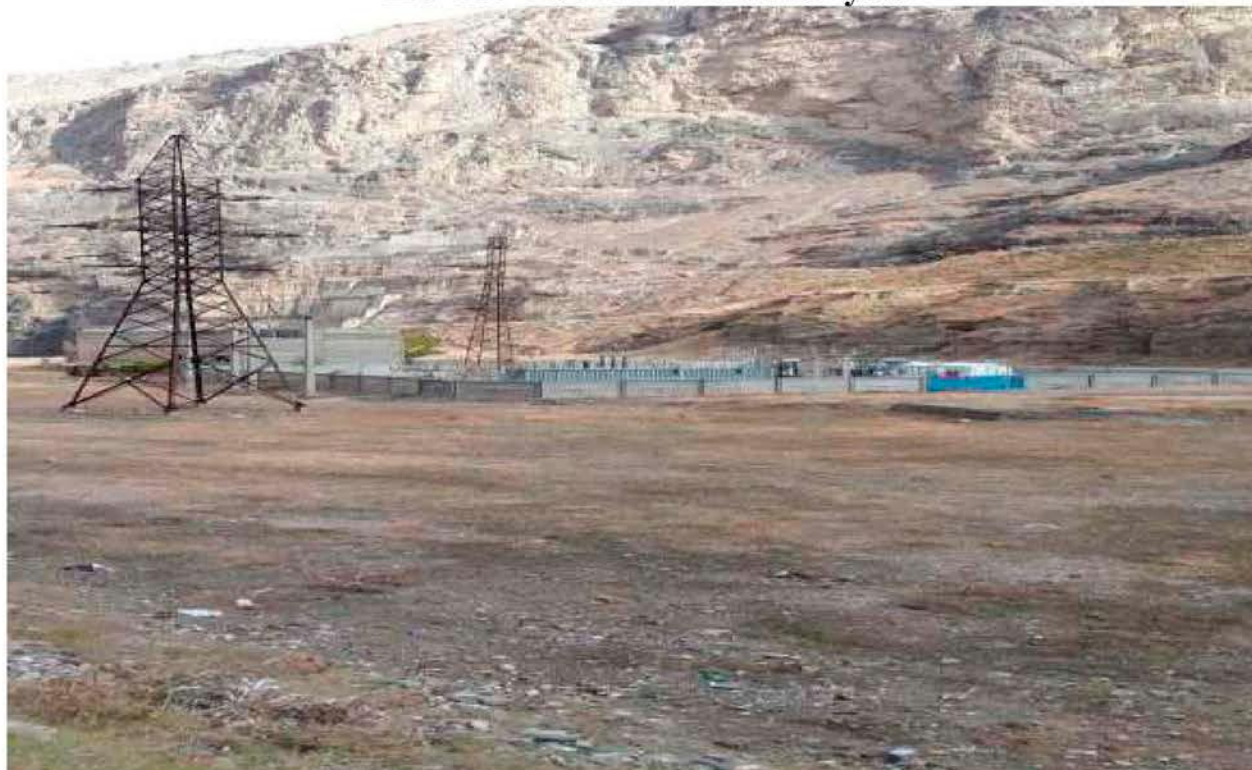
ПС-110-35/6 кВ «Головной узел»
