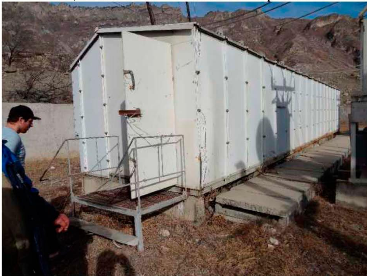
Щитовой Блок ПС-110-35/6 кВ ГПП «Ирганай»
