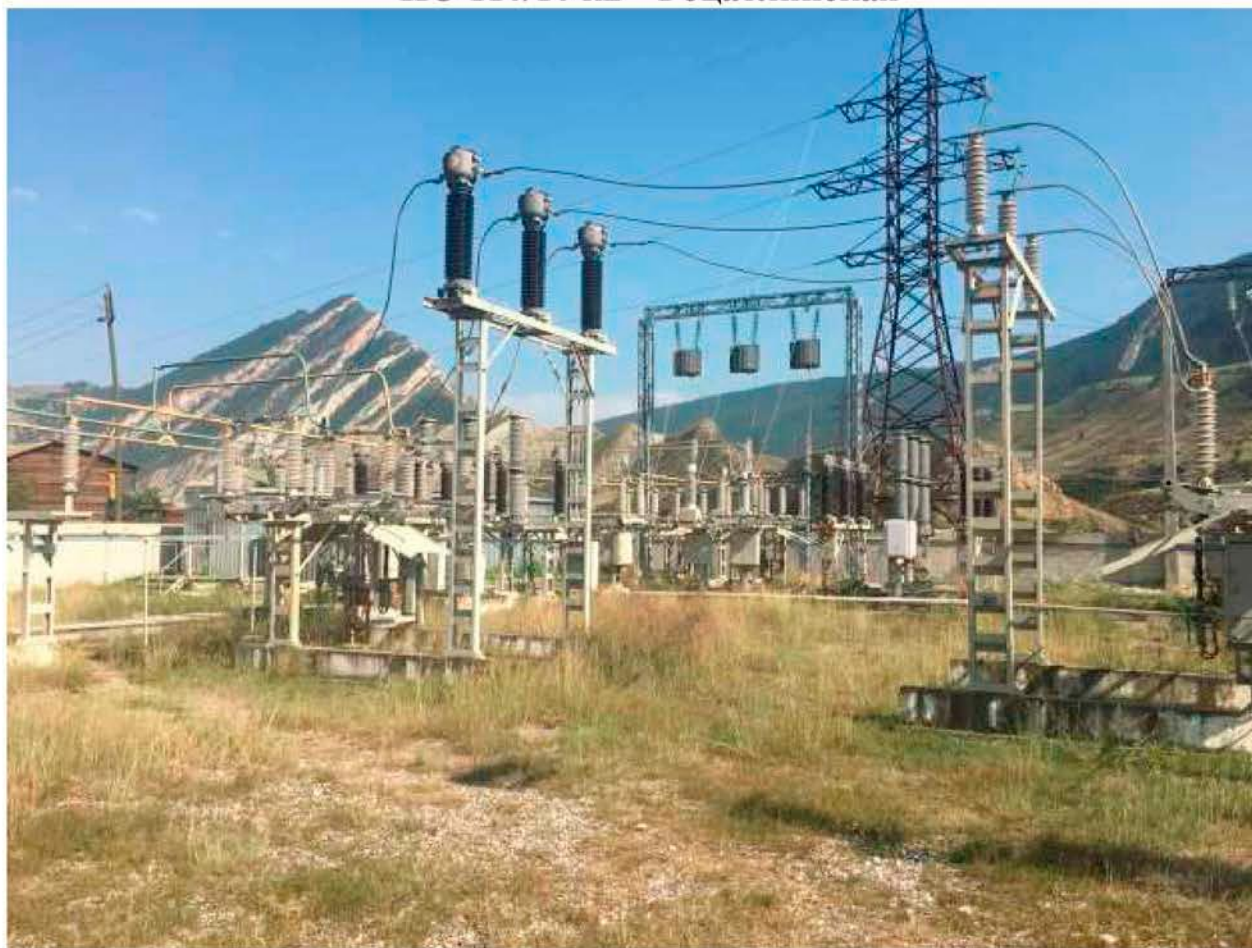
ПС-110/10 кВ "Гоцатлинская"
