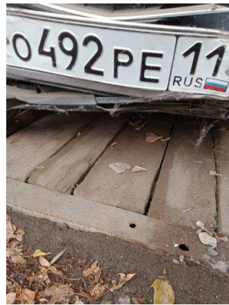
Повреждения нижней фронтальной части ТС
