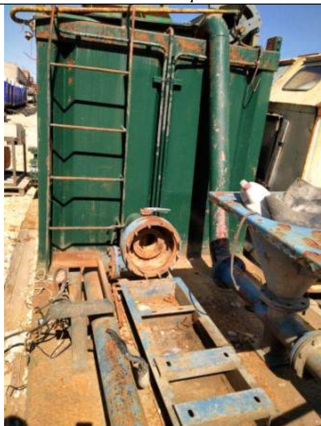
Фото 45. Система подготовки и подачи бурового раствора
