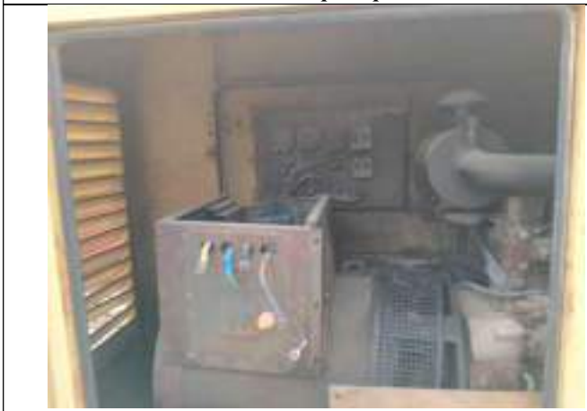
Фото 53. Фото 52. Генератор дизельный
