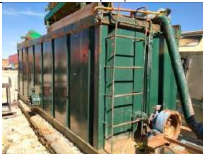
Фото 47. Система подготовки и подачи бурового раствора
