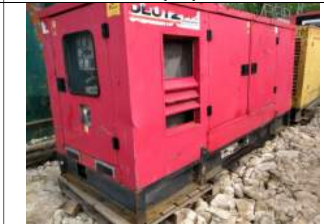
Фото 54. Электростанция Вепрь АДС 85
