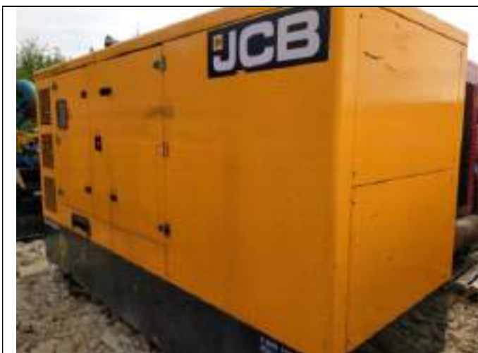
Фото 13. Дизельная электростанция (дизельный генератор) JCB-G275QX
