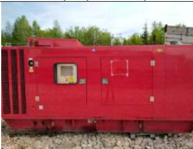
Фото 11. Дизельная электростанция(электрогенератор) THIET P275H-2, пр-во Северная Ирландия, Великобритания
