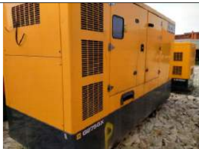
Фото 14. Дизельная электростанция (дизельный генератор) JCB-G275QX
