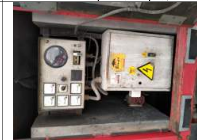
Фото 56. Электростанция Вепрь АДС 85
