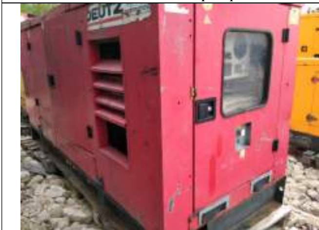
Фото 55. Электростанция Вепрь АДС 85
