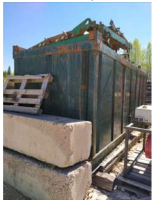
Фото 46. Система подготовки и подачи бурового раствора
