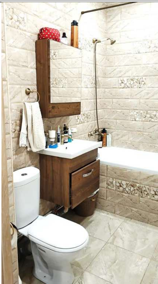
Фото 19. Состояние отделки объекта оценки, санузел
