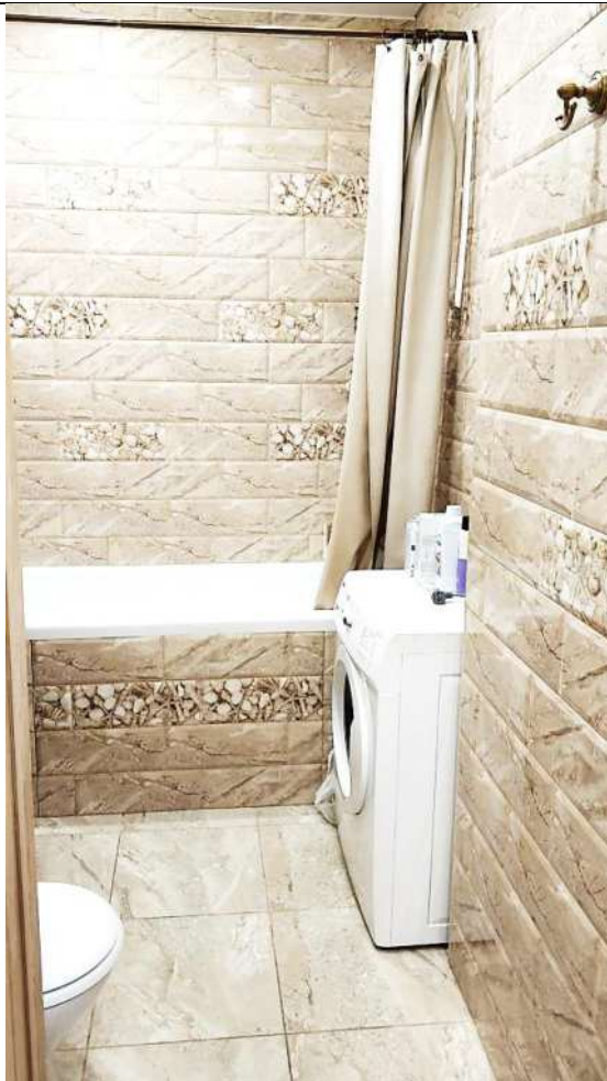
Фото 20. Состояние отделки объекта оценки, санузел
