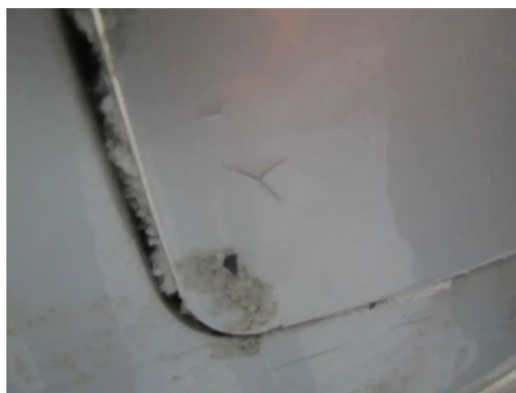
Фото №97. Дефекты эксплуатации
