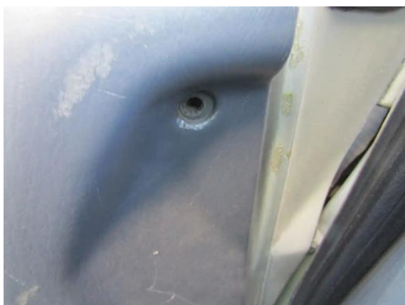
Фото №62. Дефекты эксплуатации
