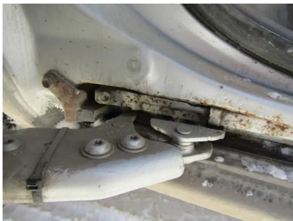
Фото №16. Дефекты эксплуатации
