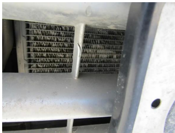
Фото №73. Дефекты эксплуатации
