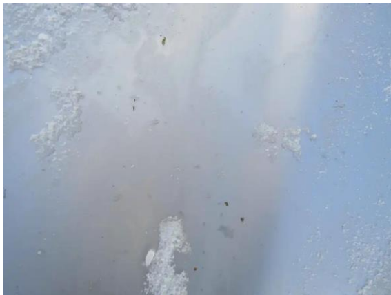
Фото №42. Дефекты эксплуатации
