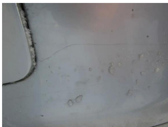
Фото №99. Дефекты эксплуатации
