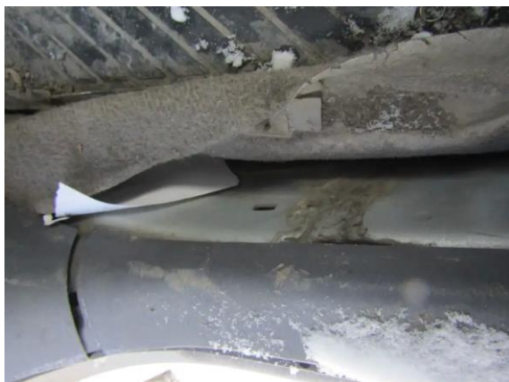
Фото №10. Дефекты эксплуатации
