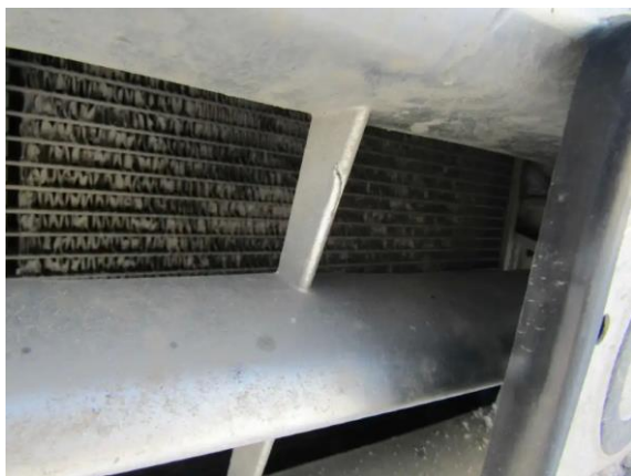
Фото №72. Дефекты эксплуатации
