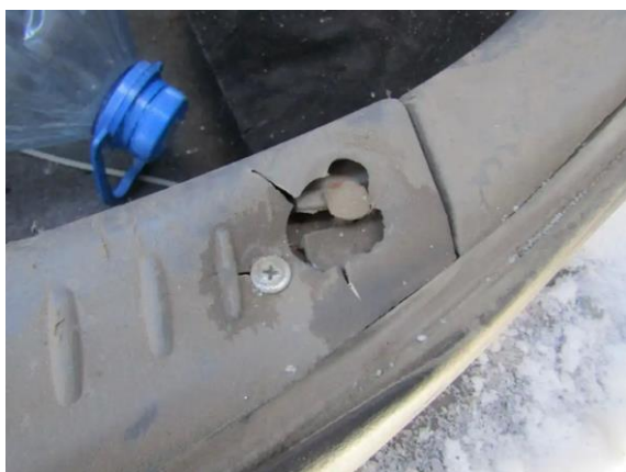
Фото №32. Дефекты эксплуатации
