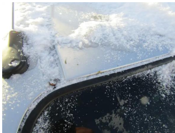
Фото №49. Дефекты эксплуатации
