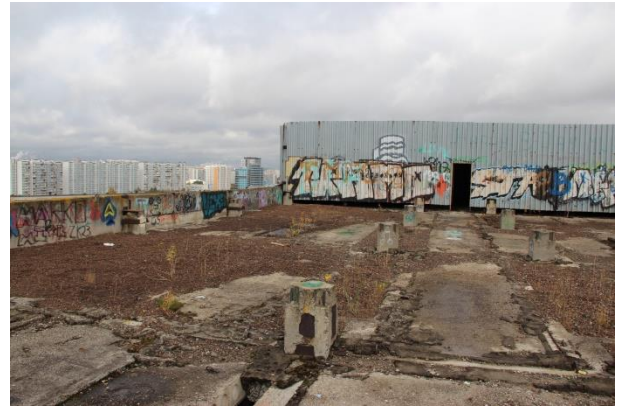
Фото 7.20. Вид на кровлю объекта незавершенного строительства кадастровый № 77:05:0006005:2257, по адресу: г. Москва, Варшавское ш., д.125, корп. 3
