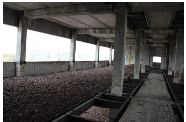
Фото 7.16. Вид на конструктивные строительные элементы объекта незавершенного строительства кадастровый № 77:05:0006005:2257, по адресу: г. Москва, Варшавское ш., д.125, корпус 3
