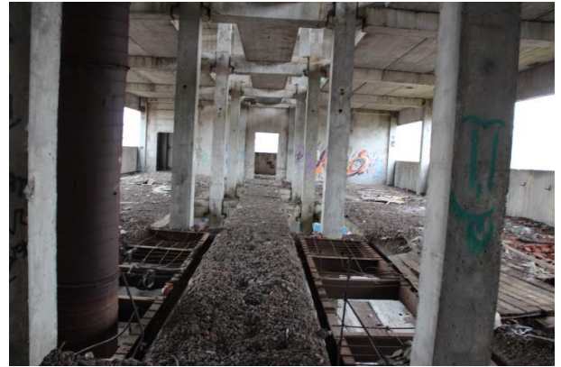
Фото 7.14. Вид на конструктивные строительные элементы объекта незавершенного строительства кадастровый № 77:05:0006005:2257, по адресу: г. Москва, Варшавское ш., д.125, корпус 3
