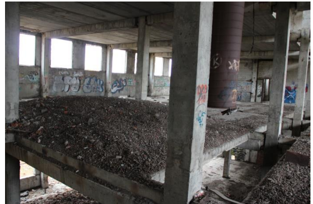
Фото 7.12. Вид на конструктивные строительные элементы объекта незавершенного строительства кадастровый № 77:05:0006005:2257, по адресу: г. Москва, Варшавское ш., д.125, корпус 3
