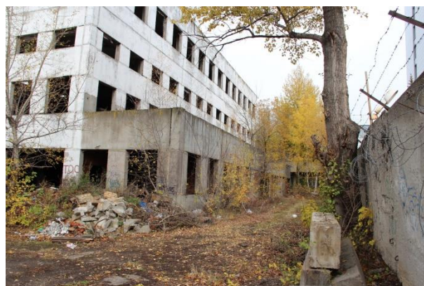
Фото 7.4 Вид на объект незавершенного строительства кадастровый № 77:05:0006005:2257, по адресу: г. Москва, Варшавское ш., д.125, корпус 3
