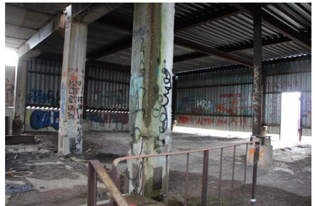
Фото 7.18. Вид на конструктивные строительные элементы объекта незавершенного строительства кадастровый № 77:05:0006005:2257, по адресу: г. Москва, Варшавское ш., д.125, корпус 3
