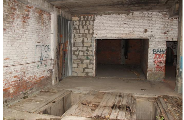
Фото 7.8 Вид на конструктивные строительные элементы объекта незавершенного строительства кадастровый № 77:05:0006005:2257, по адресу: г. Москва, Варшавское ш., д.125, корпус 3
