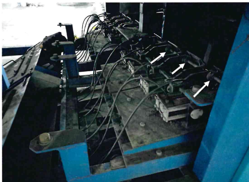
Фото 8. Пневматический исполнительный механизм. Сильное загрязнение в шарнирах механизма.
