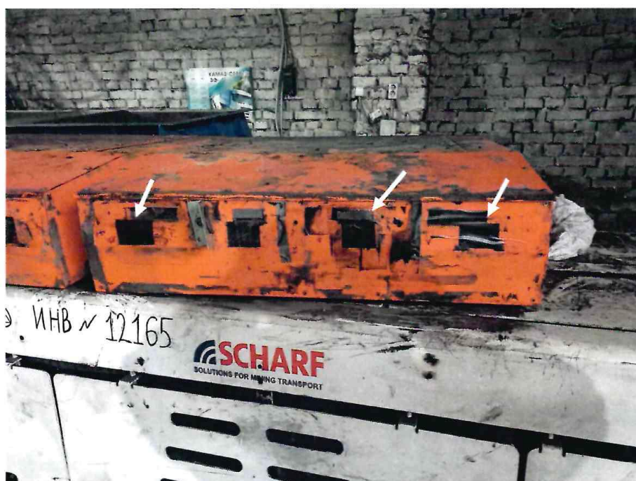
Фото 7. Рентгеновская установка (демонтирована). Защитные экраны окошек излучателей частично отсутствуют, частично имеют повреждения.
