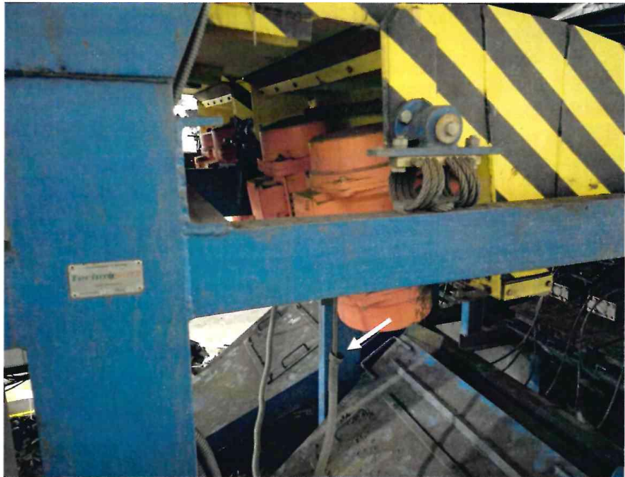
Фото 5. Вибростол с вибраторами. Нарушено крепление металлорукава кабеля питания вибратора.
