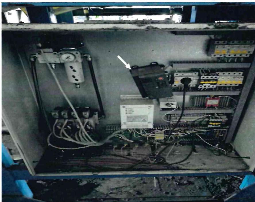
Фото 9. Шкаф электрооборудования. Нарушено крепление составных частей электрооборудования.
