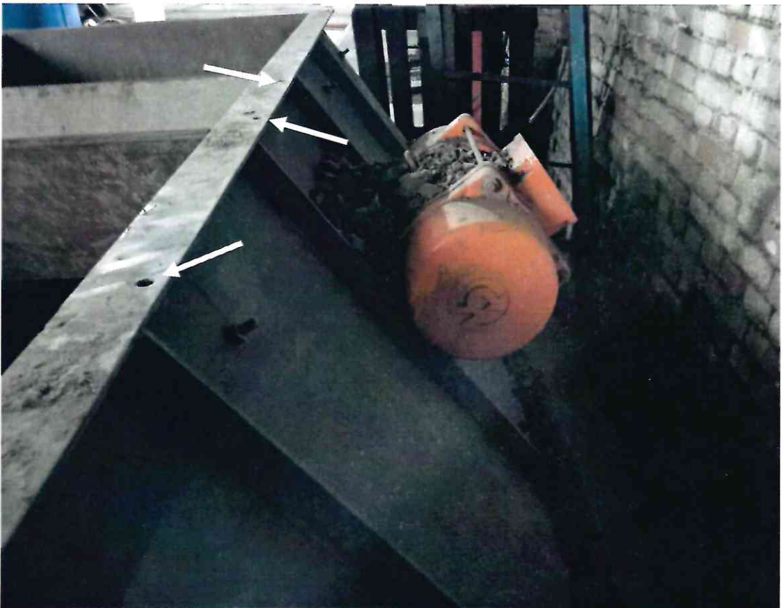
Фото 6. Приемный бункер с вибратором. Отсутствуют 100% болтов крепления бункера к раме сепаратора.
