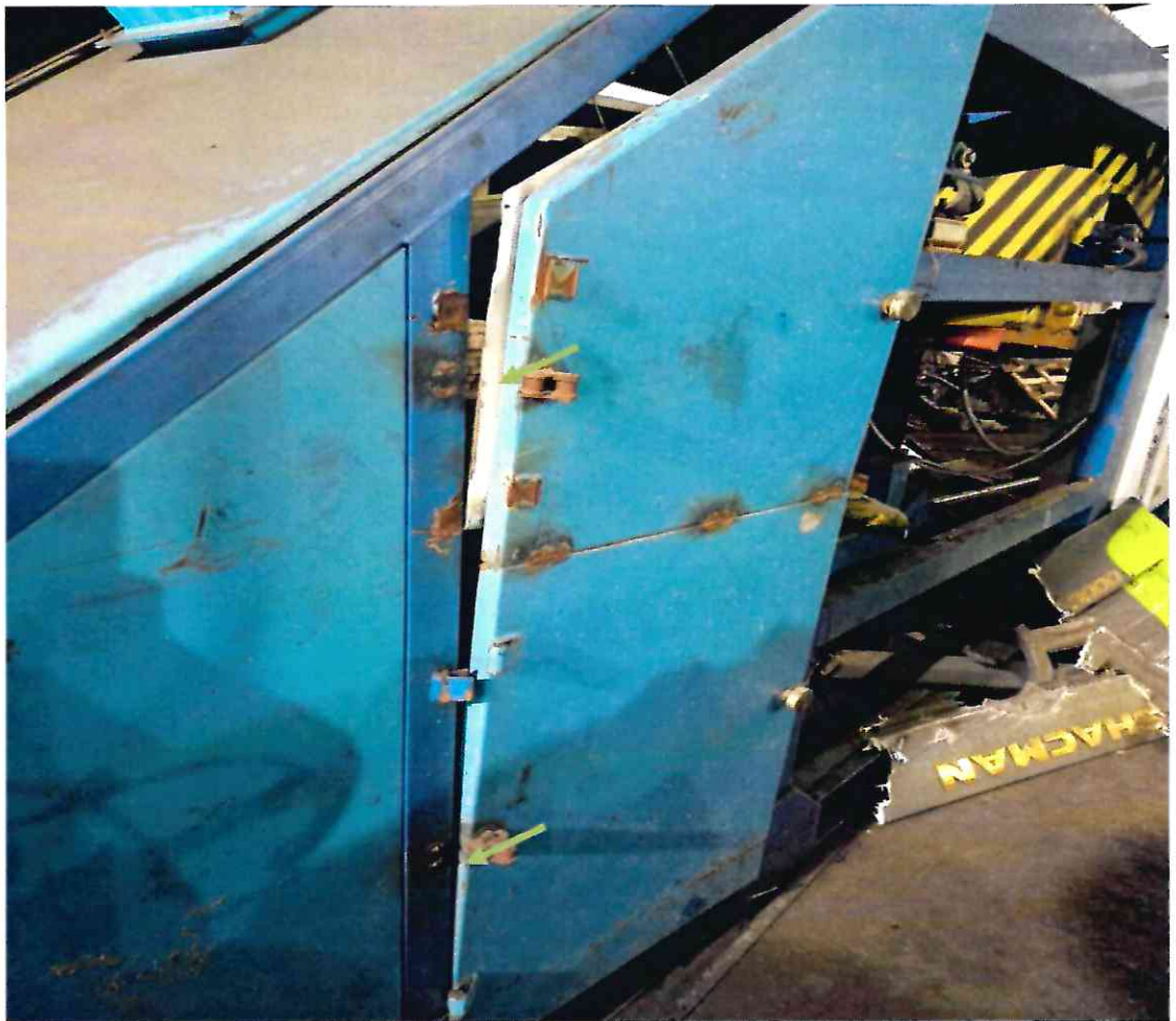
Фото 3. Повреждение петель крепления (обрыв) защитных люков сепаратора.
