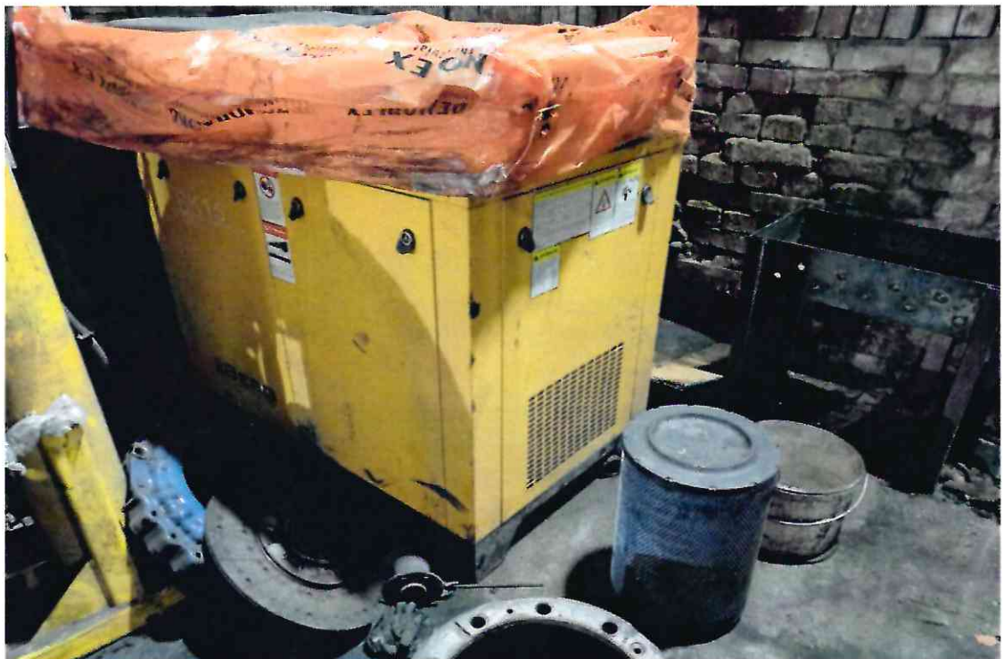
Фото 10. Компрессор BERG BK15. Незначительные деформации и загрязнения кожуха компрессора.
