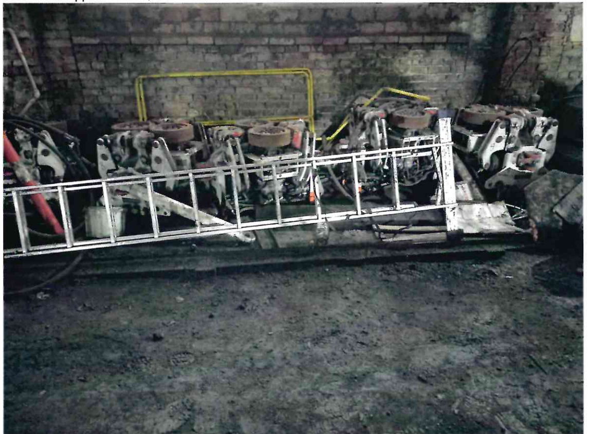
Фото 2. Приводные механизмы и соединительные штанги
