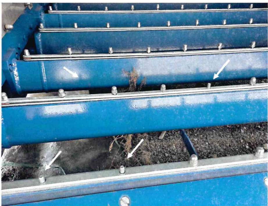
Фото 3. Отсутствуют полиуретановые сита на обеих деках и часть крепежа сит.
