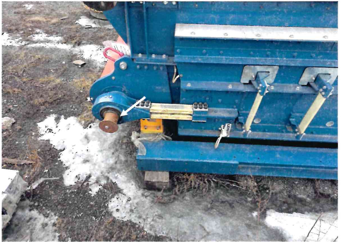
Фото 2. Отсутствует привода грохота
