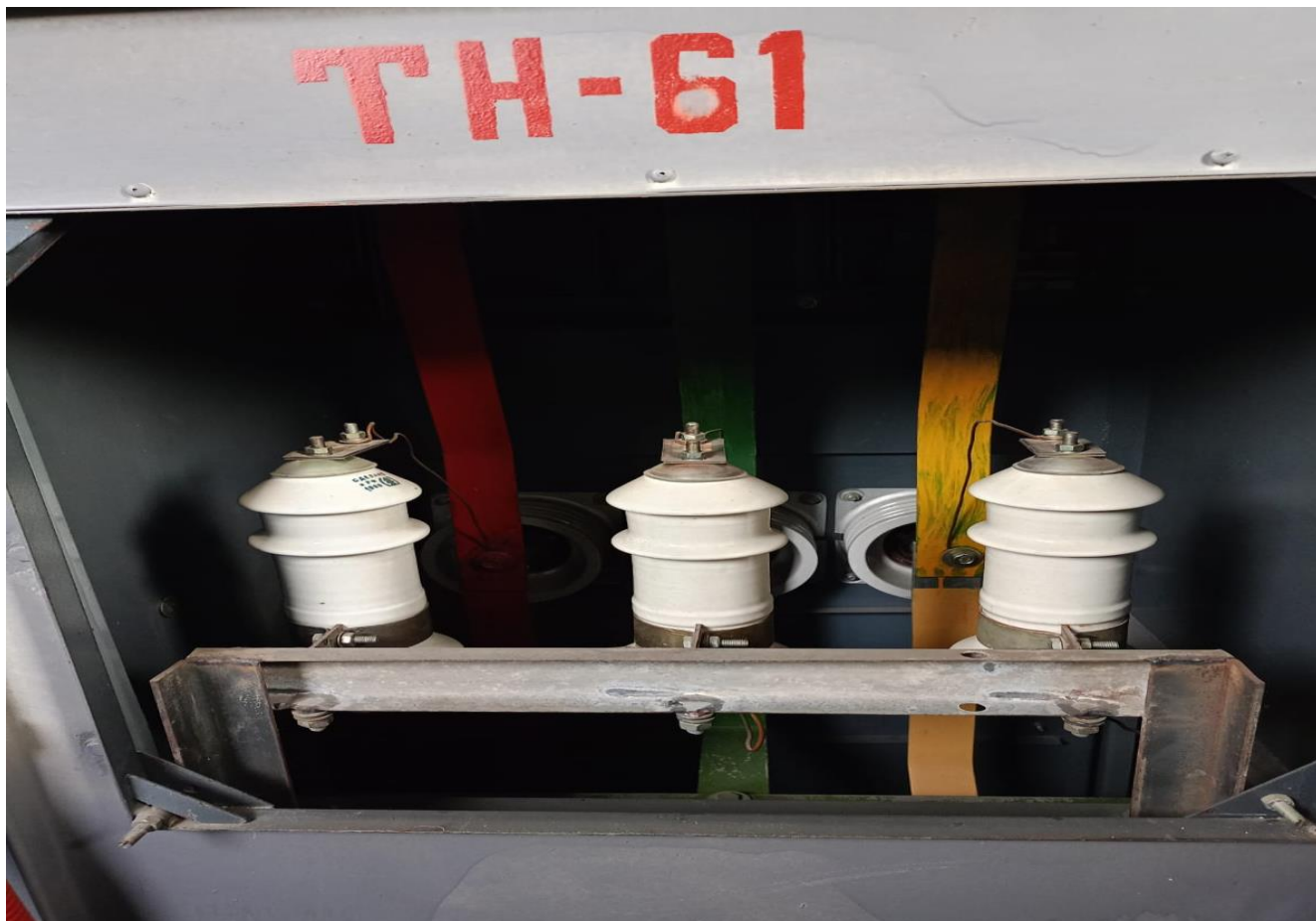
Разрядник РВП-6 ГЭС3 РВ-61
