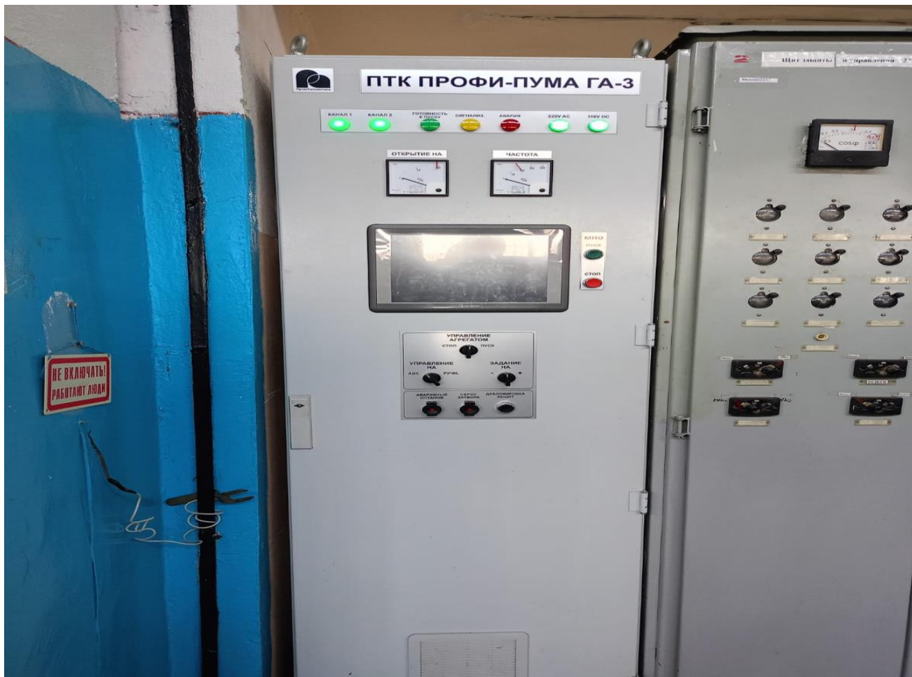
АСУ гидроагрегата ГЭС 3 (ПУМА)
