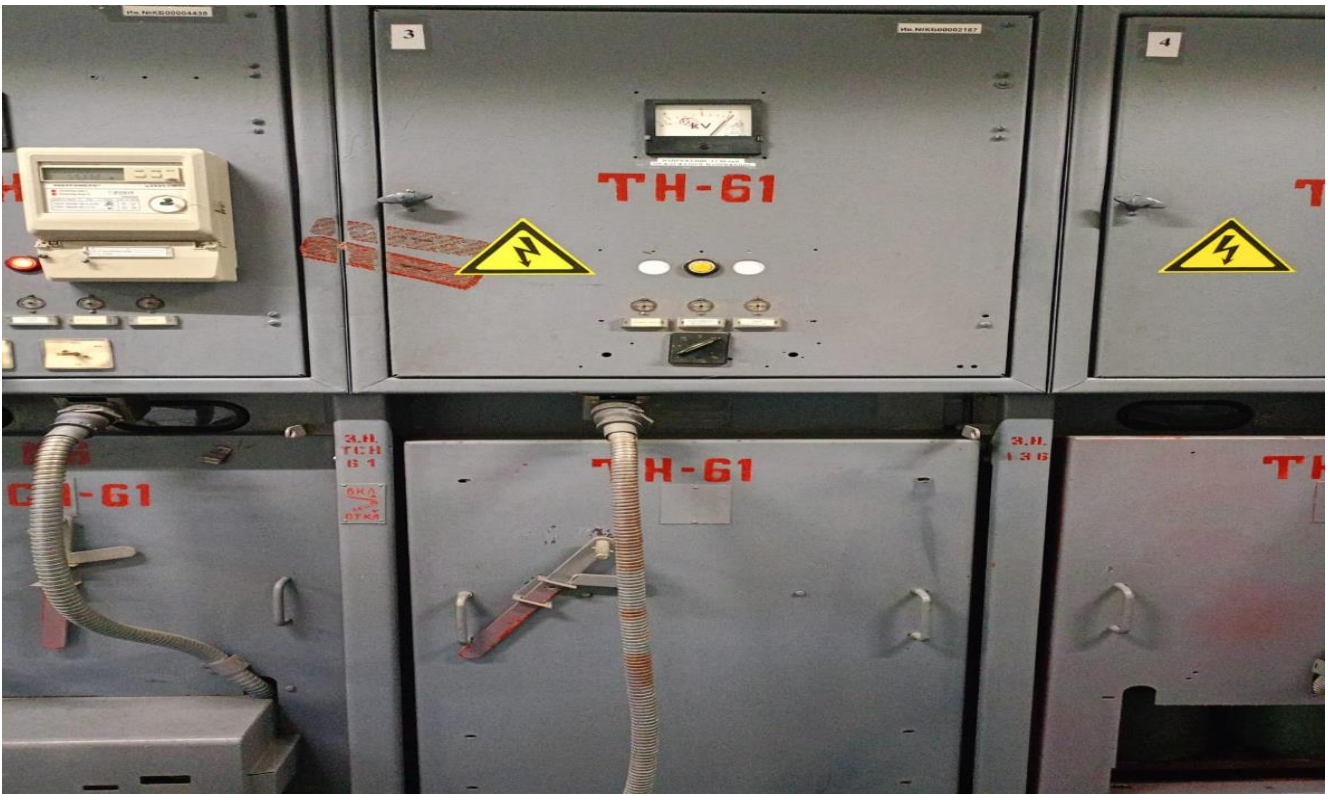
Трансформатор напряжения высоковольтный НАМИ-6 ГЭС-3 ТН-61
