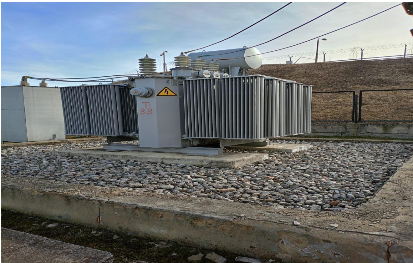
Трансформатор силовой ТМ 4000/35 У1 ГЭС-3
