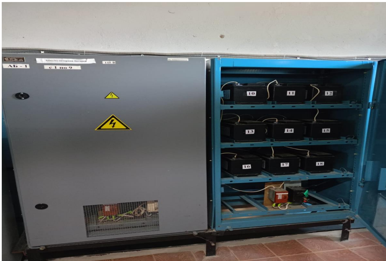
Батарея аккумуляторная щелочная ГЭС-3
