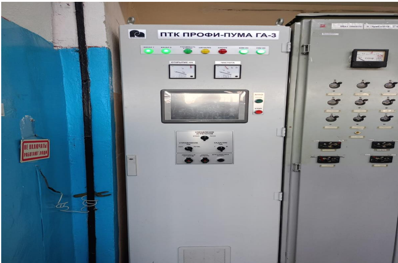
Щит агрегатный управления гидроагрегата ГЭС 3
