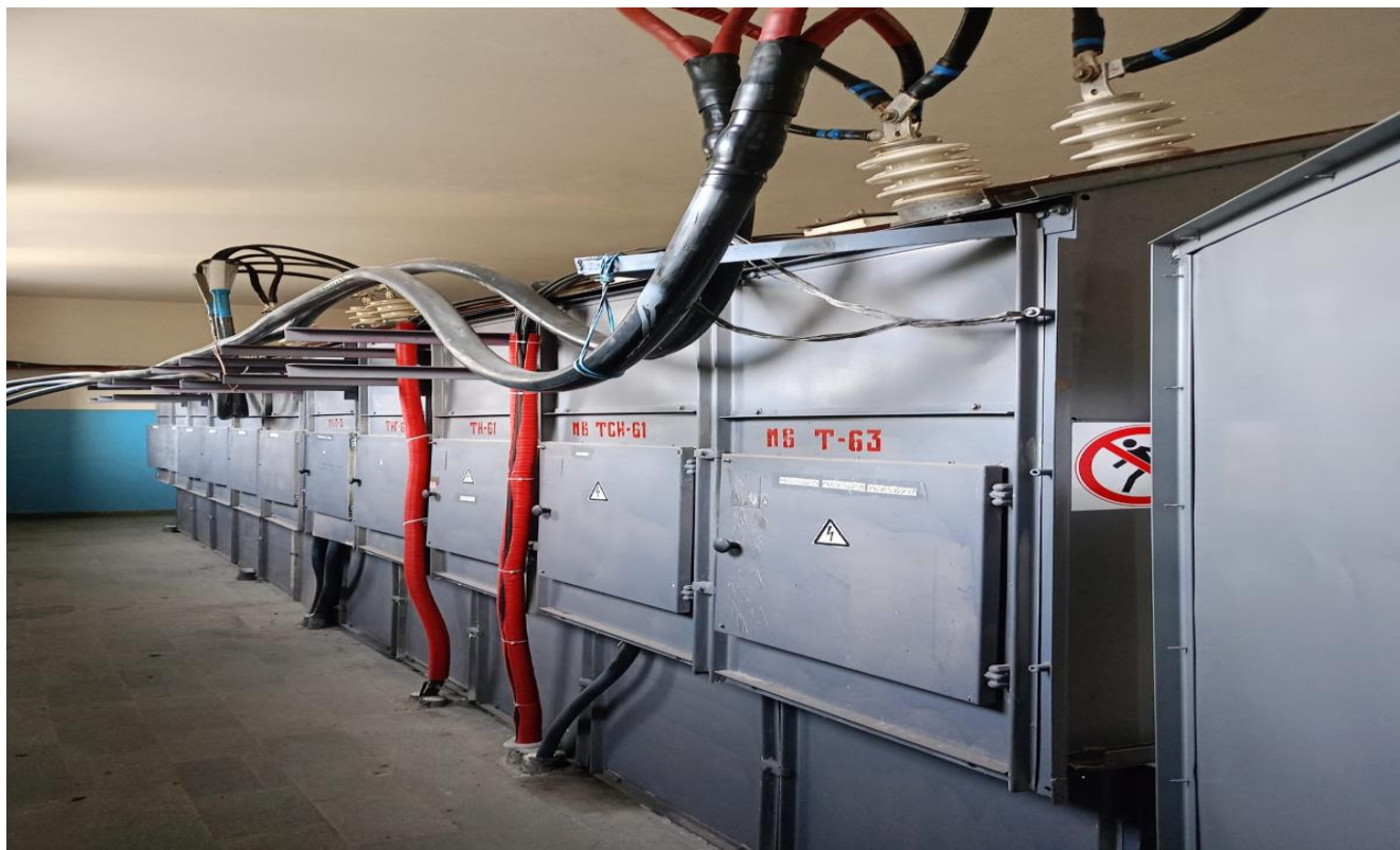
Система шин ГЭС 3 1СШ-6кВ
