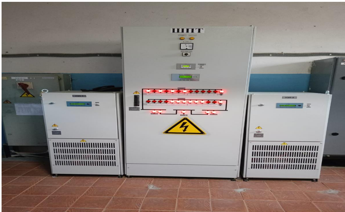
Шкаф управления оперативного тока ШУОТ 2403-33 №1 ГЭС-3
