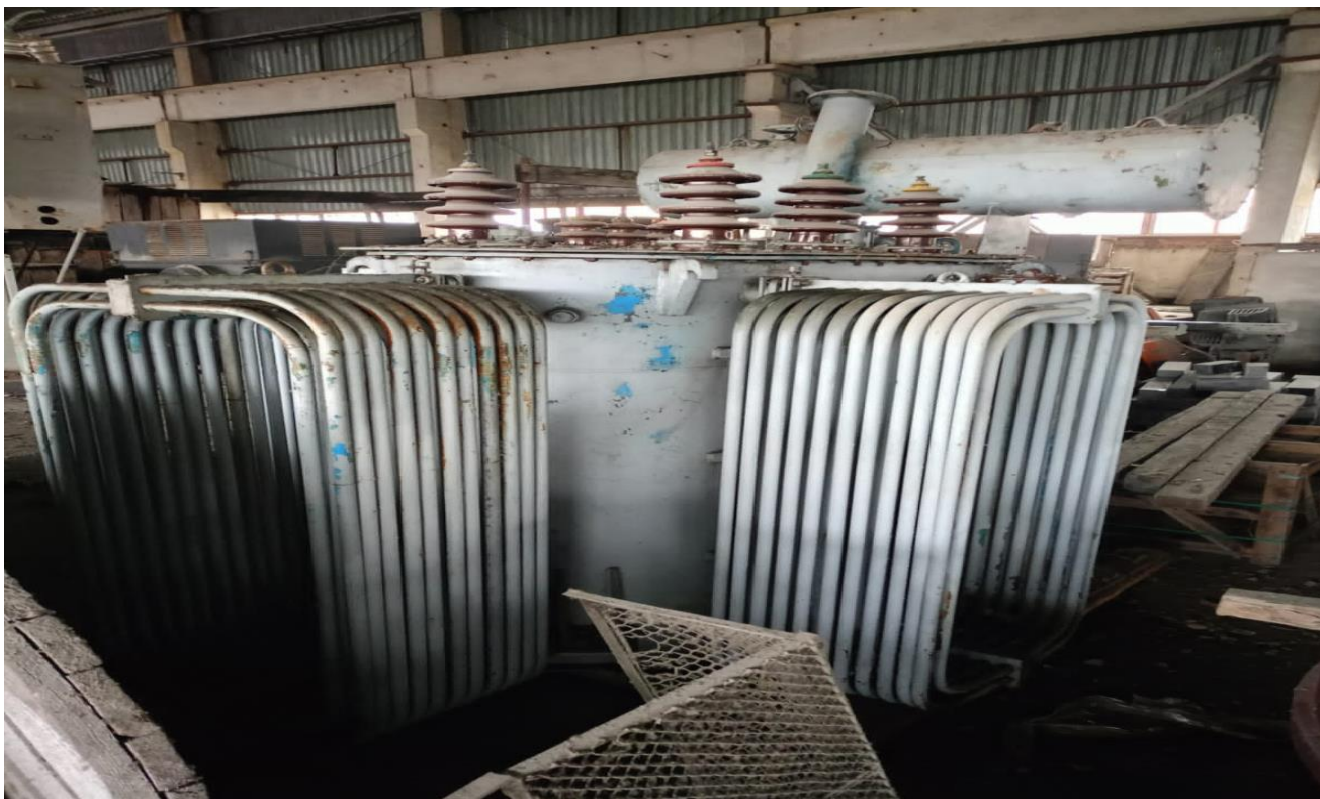
Трансформатор силовой Т-32 НГЭС
