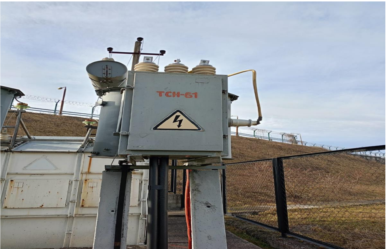
Трансформатор ТМ-250/6-У1/0,4 ГЭС 3 ТСН-61
