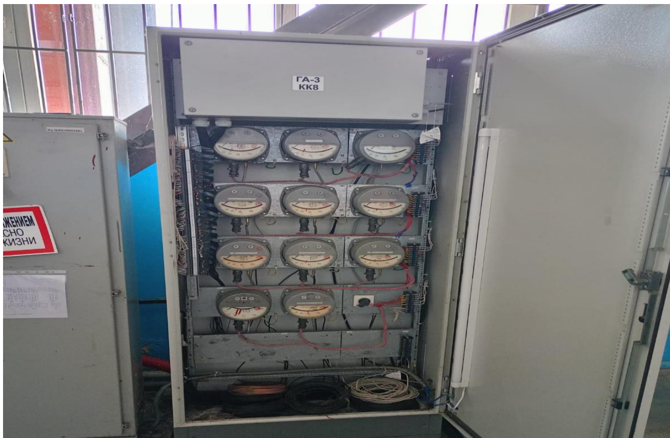
Шкаф теплоконтроля генератора УТКГ УХЛ-4 ГЭС-3
