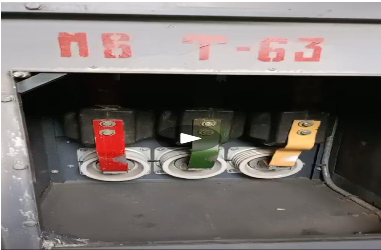
Трансформатор тока высоковольтный ТОЛ 10-1 Г-3 Фаза В ГЭС-3
