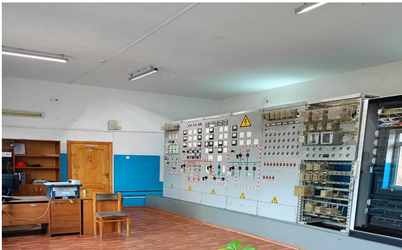
Главный щит управления ГЭС 3
