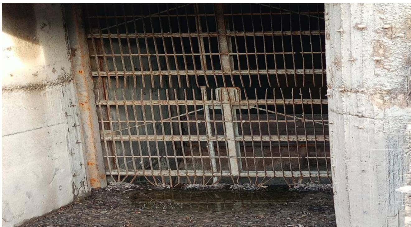
Решетка сороудерживающая Здание лебедочной водоприемника ГЭС-3
