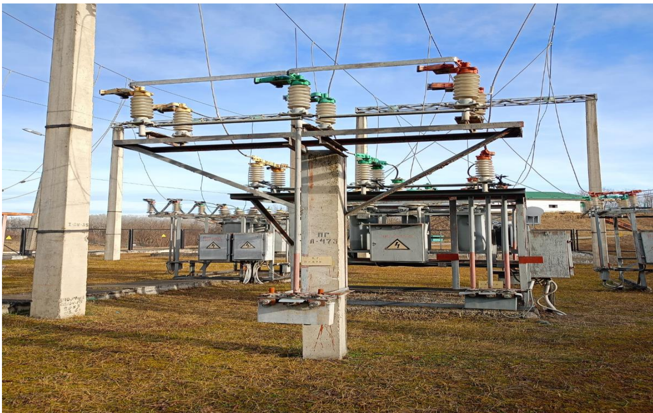
Разъединитель высоковольтный РЛНД -35/630 ГЭС 3 Л-473-ПГ
