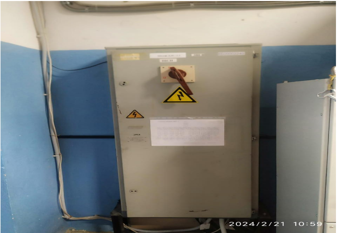
Шкаф распределительный ГЭС 3
