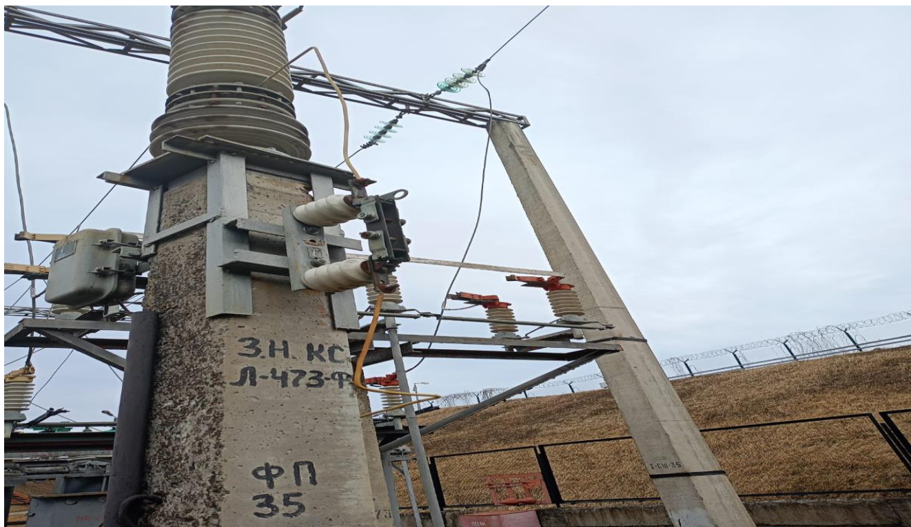
Конденсатор связи СМР-33 ГЭС 3 КС Л-473
