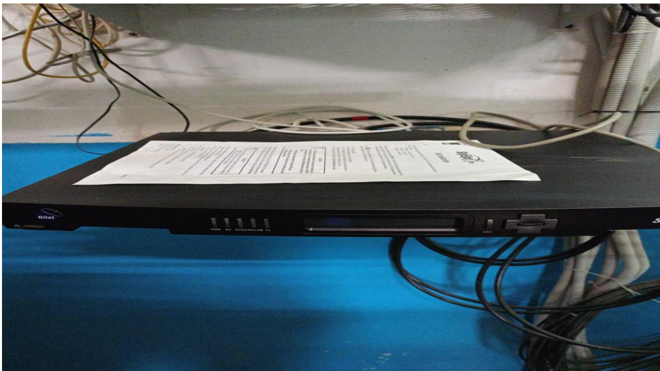
Оборудование резервного спутникового канала связи ЗССС ГЭС-3
