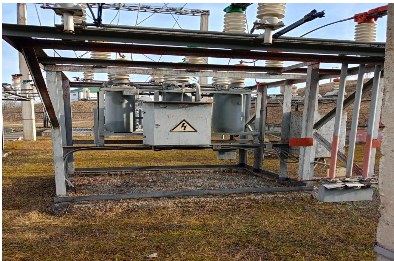
Выключатель высоковольтный масляный ВТ-35/630 МВ Л-473 ГЭС-3
