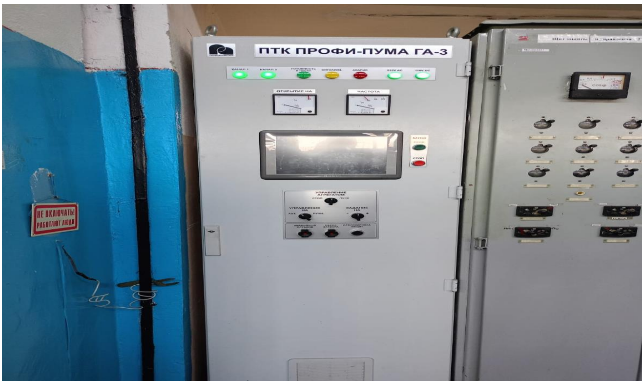
Система управления агрегата ГЭС-3
