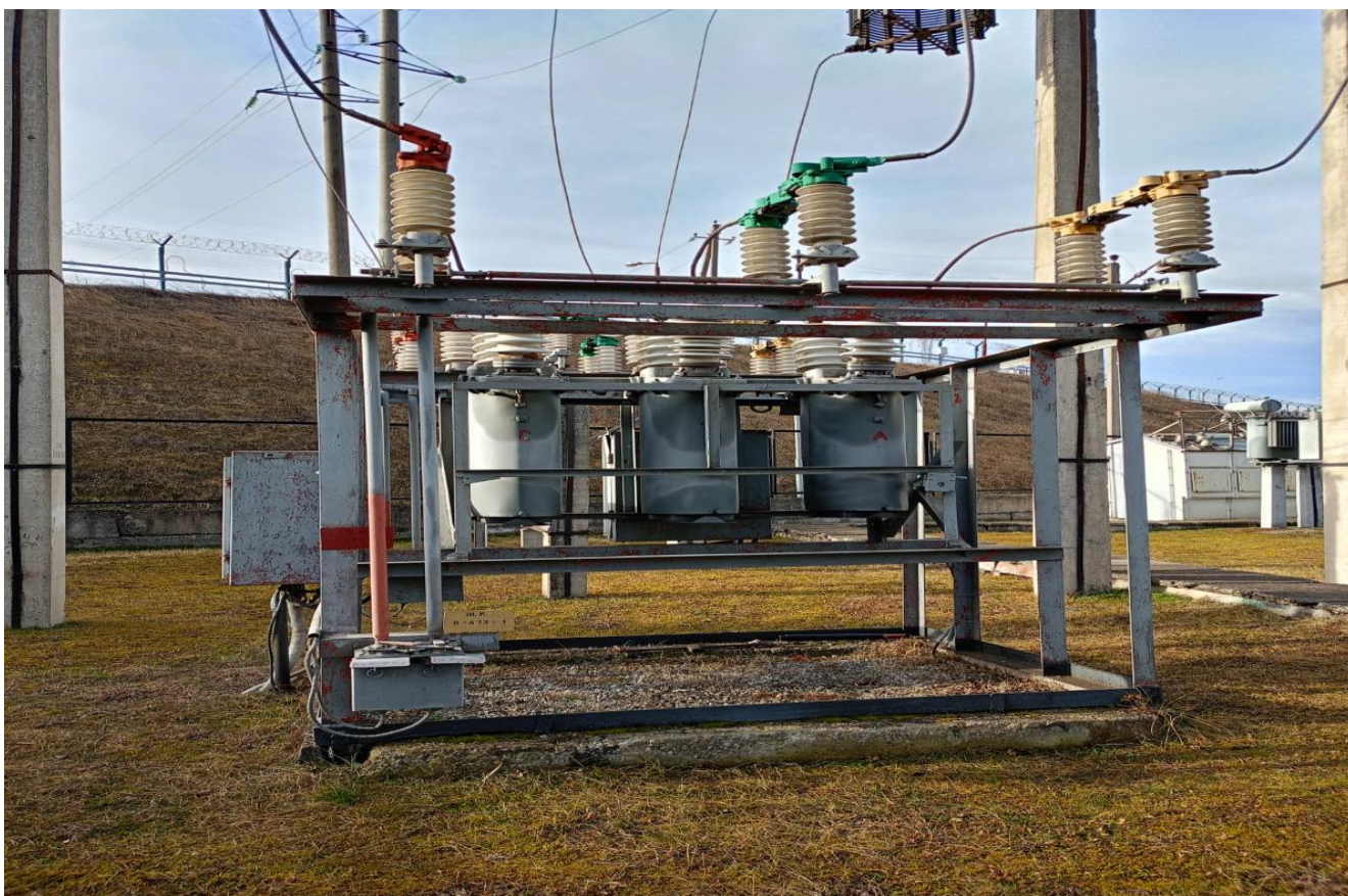
Разъединитель высоковольтный РД32-35/630 ГЭС 3 Л-473-Л
