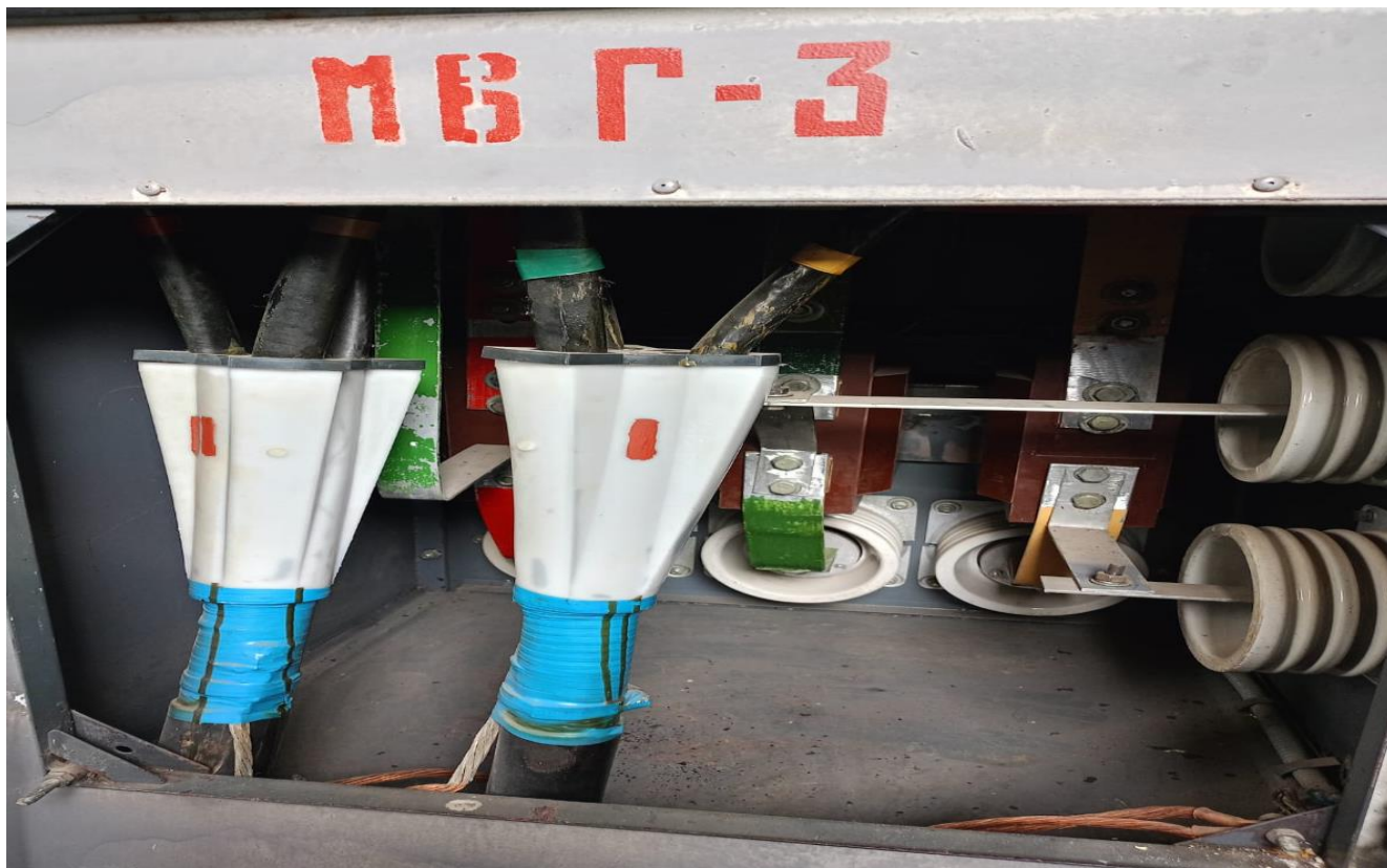
Трансформатор тока высоковольтный ТОЛ 10 1 СШ 6кВ Фаза А ГЭС 3
