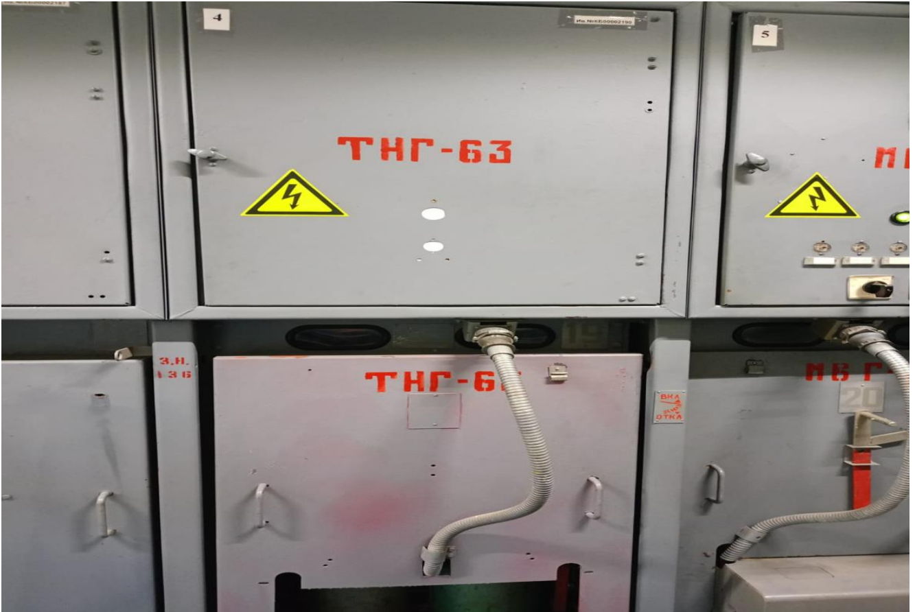
Трансформатор напряжения высоковольтный НОМ-6 ГЭС 'З ТНГ-63
