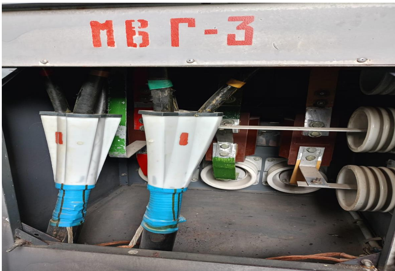
Трансформатор тока высоковольтный ТОЛ 10 1 СШ 6кВ Фаза С ГЭС 3
