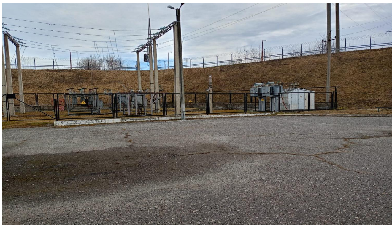
ОРУ – 35 кВ ГЭС-3
