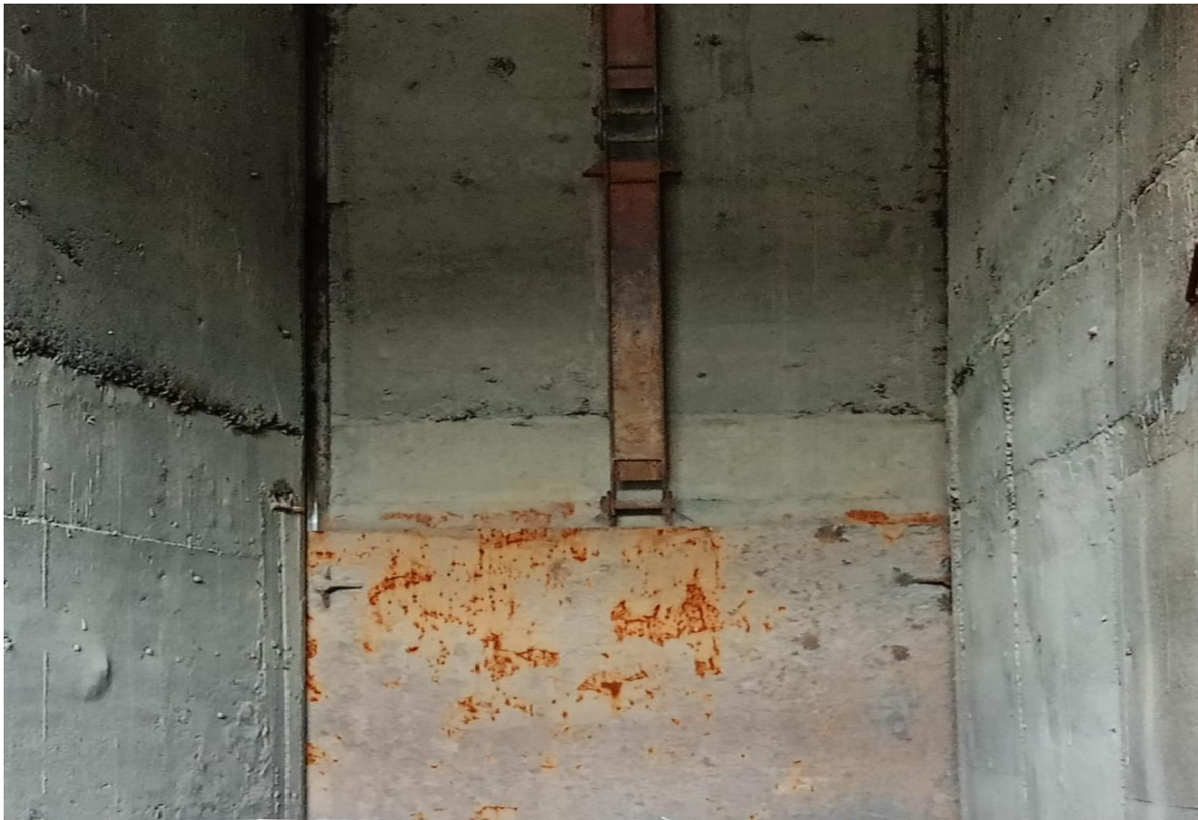
Затвор основной (рабочий, плоский колесный ) №3, Здание лебедочной водоприемника ГЭС-3
