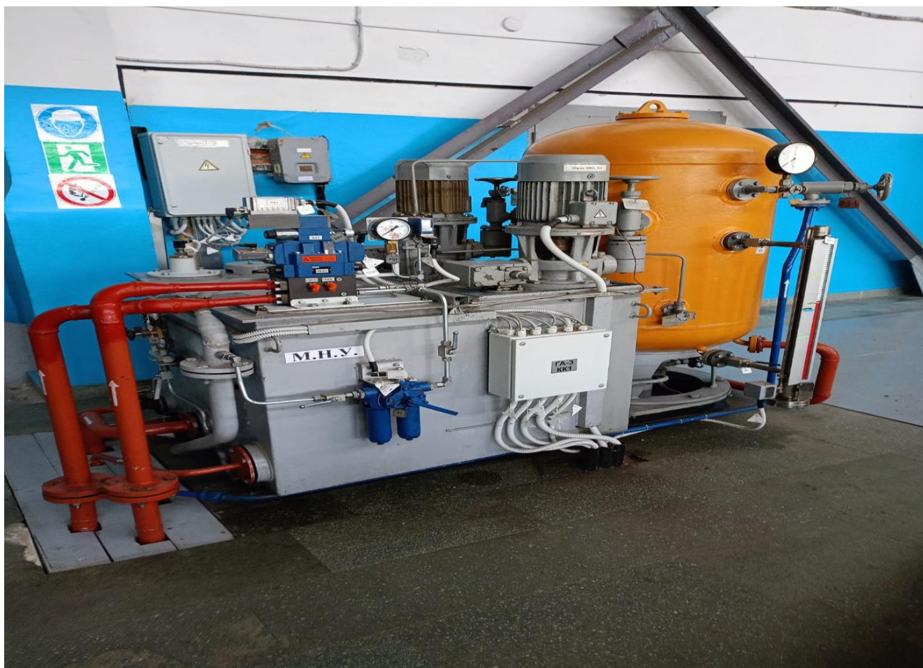
Установка маслonaпорная МНУ-3 0,63/1-25 ГЭС 3
