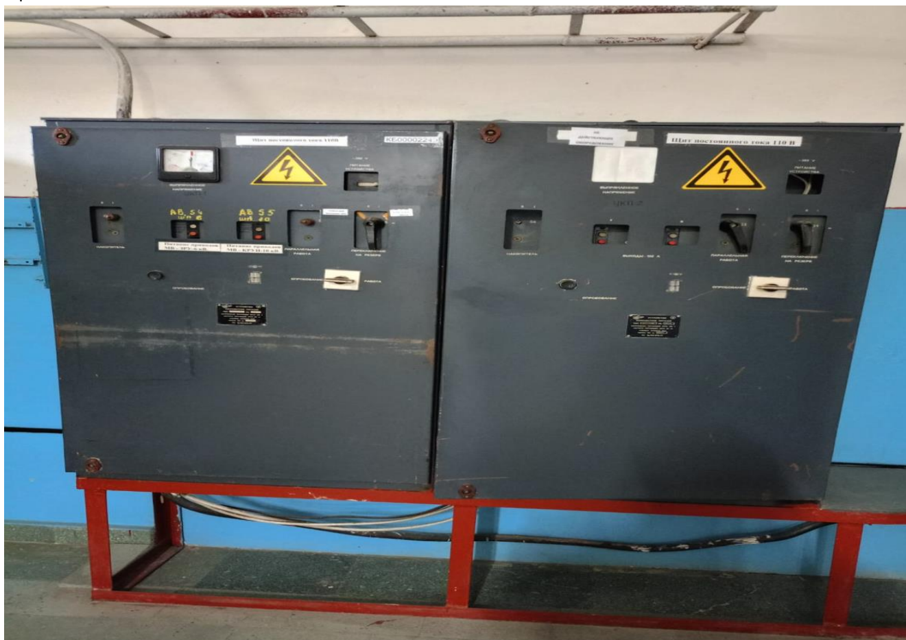
Щит постоянного тока №1 УКП-К 380 В ГЭС 3
