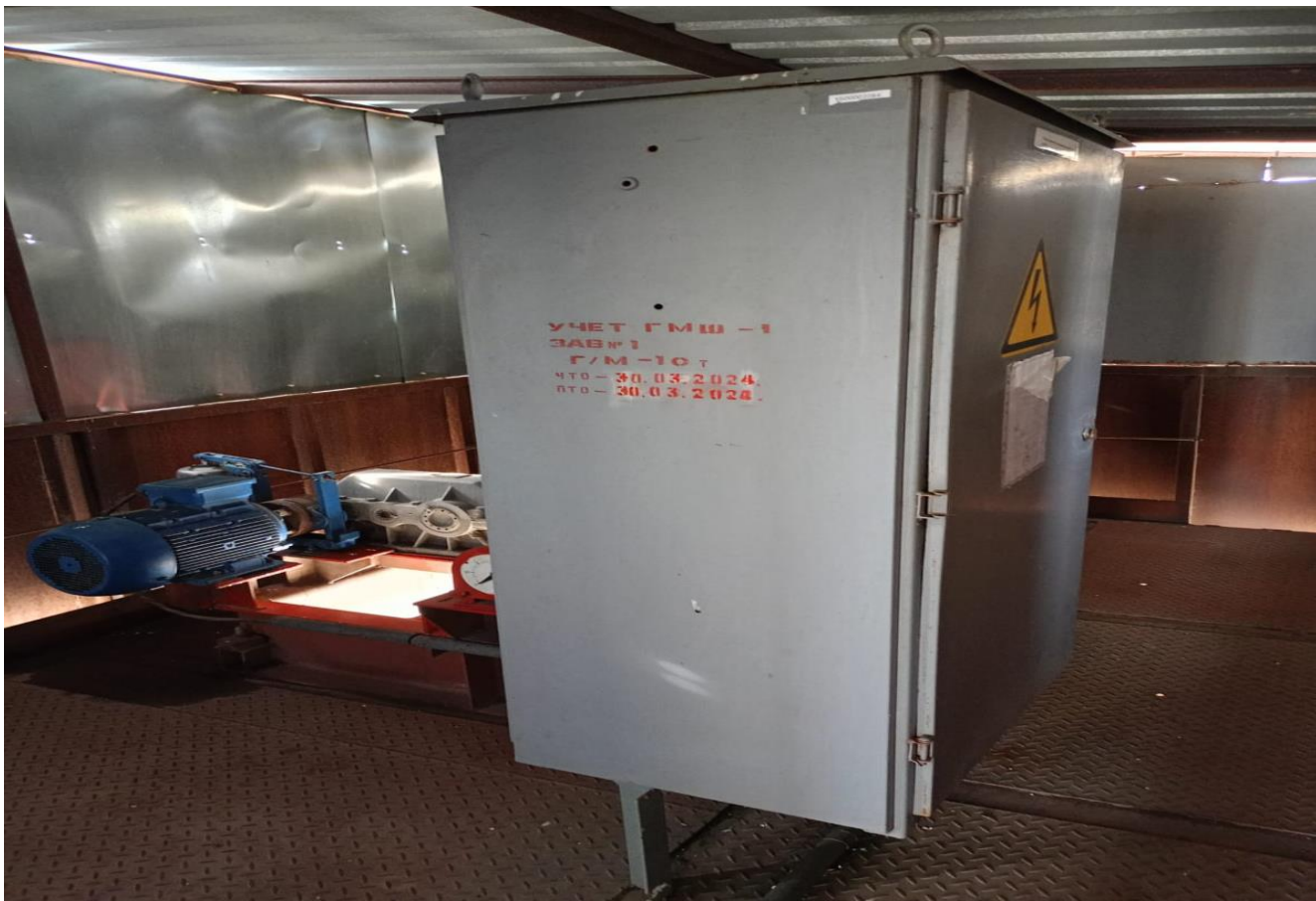
Щит управления канатным механизмом №1 ШР ГЭС-3
