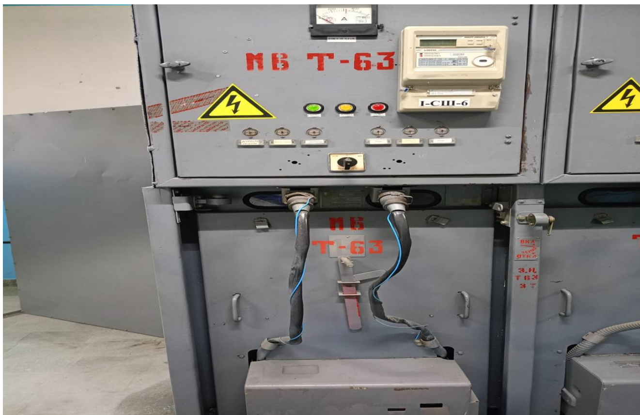
Выключатель высоковольтный маломасляный ВК10/400 ГЭС3 МВ - Т-63
