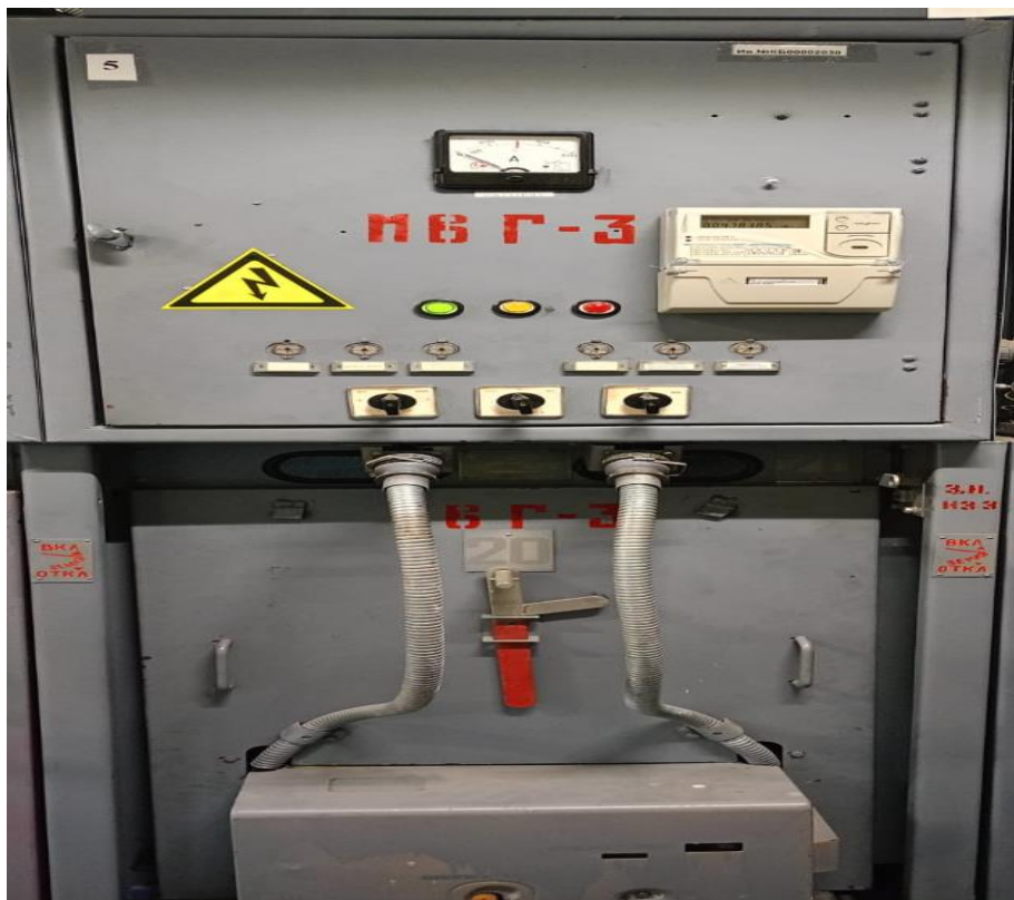
Выключатель высоковольтный маломасляный ВК10/400 ГЭСЗ МВ Г-3
