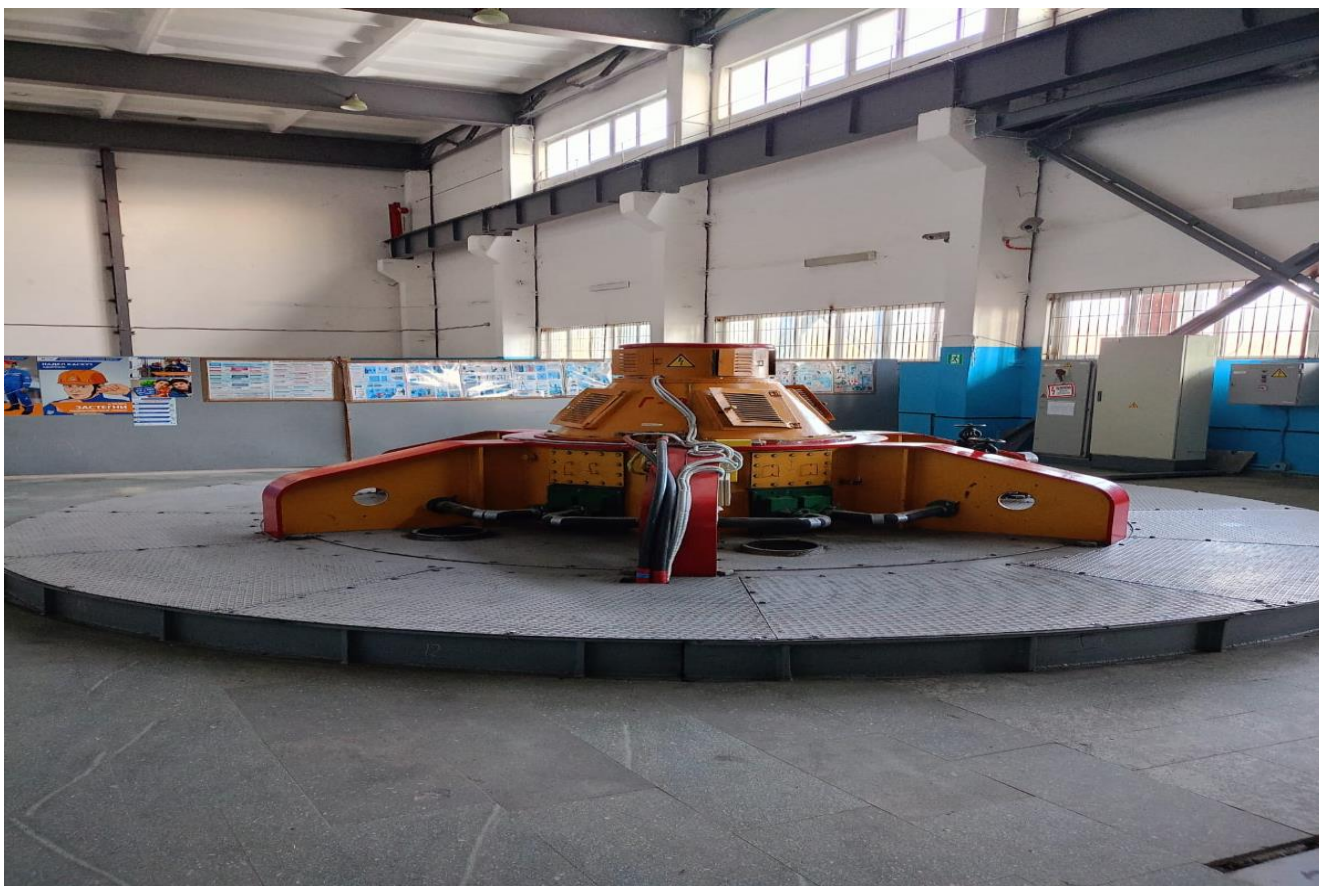
Генератор синхронный к гидравлической турбине вертикальной СМВ 4000-18 УХЛ-4 ГЭС 3
