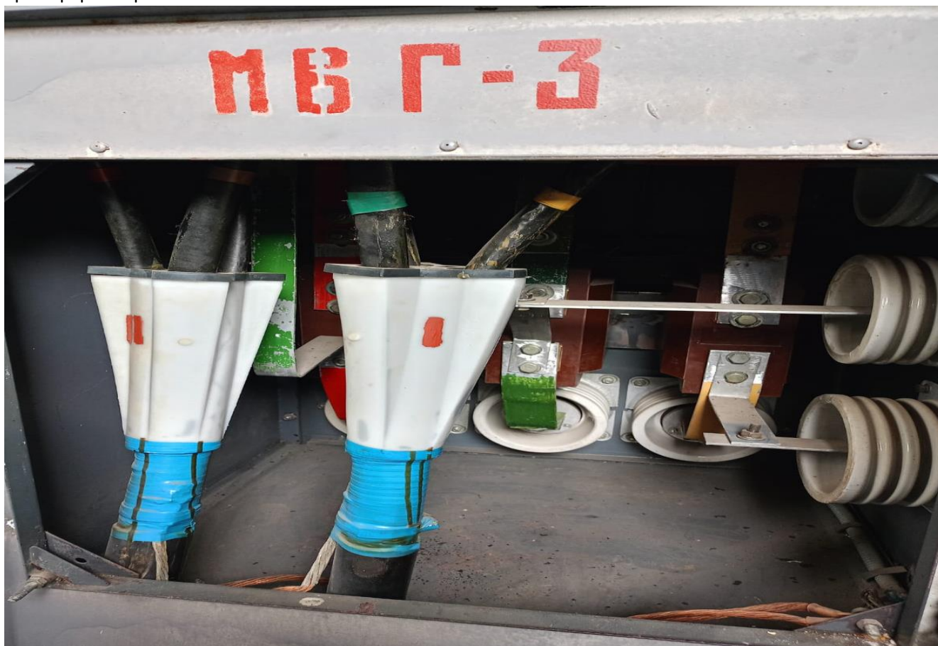
Трансформатор тока высоковольтный ТОЛ 10-1 Г-3 Фаза С ГЭС-3
