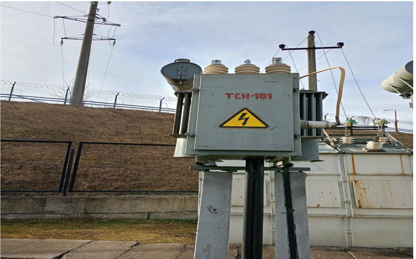
Трансформатор ТМ-250/10-У1/0,4 ГЭС 3 ТСН-101
