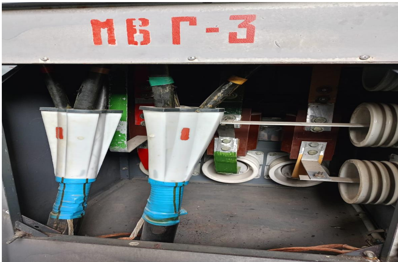
Трансформатор тока высоковольтный ТОЛ 10 1 СШ 6кВ Фаза В ГЭС 3
