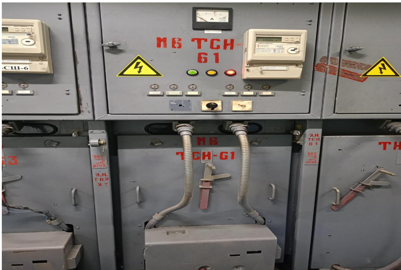
Выключатель высоковольтный маломасляный ВК10/400 ГЭСЗ МВ ТСН-61
