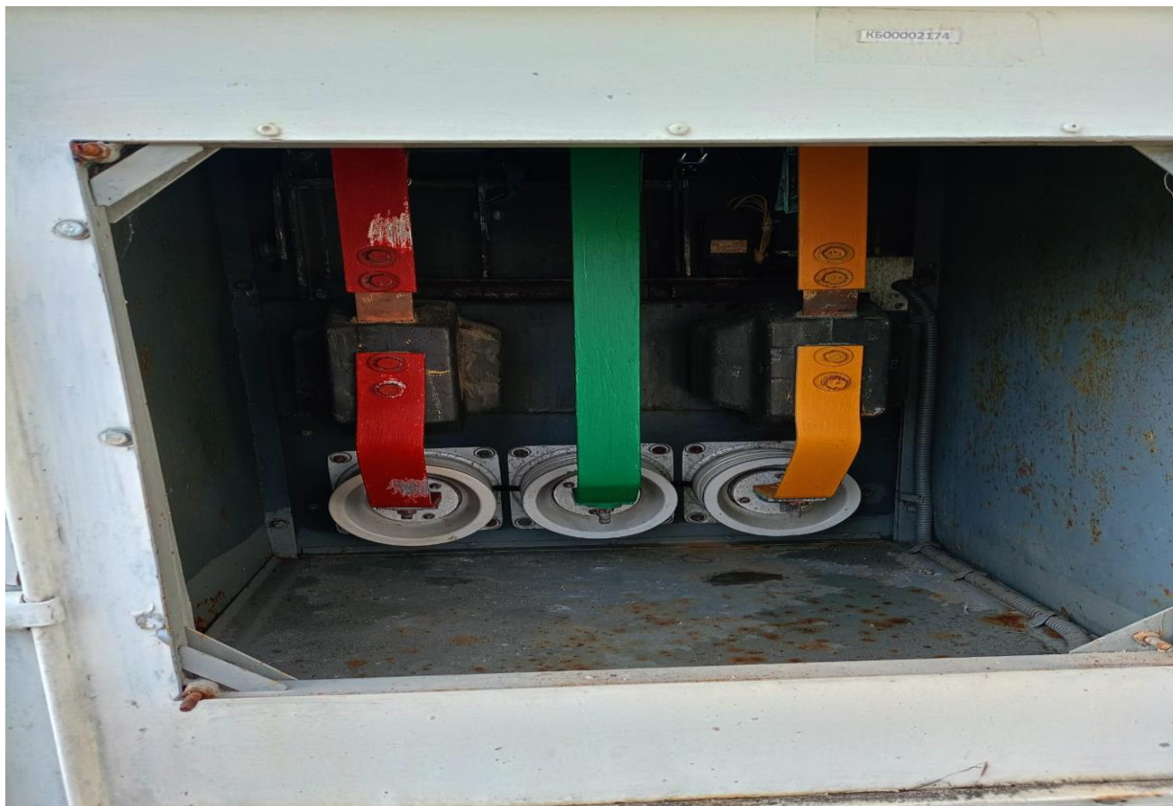
Система шин ГЭС 3 1СШ-10кВ
