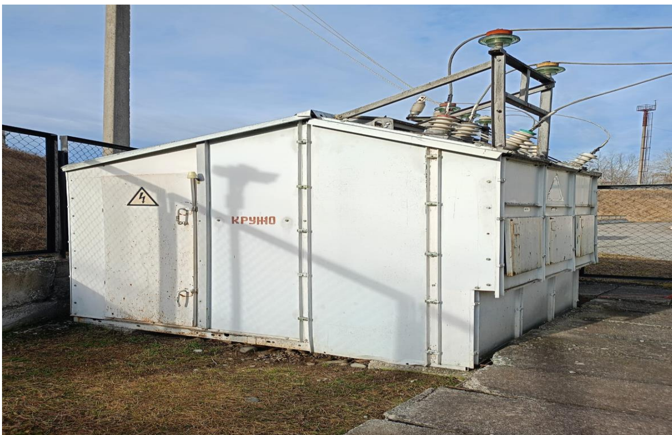
Комплектное распределительное устройство КРУН-10 кВ ГЭС-3
