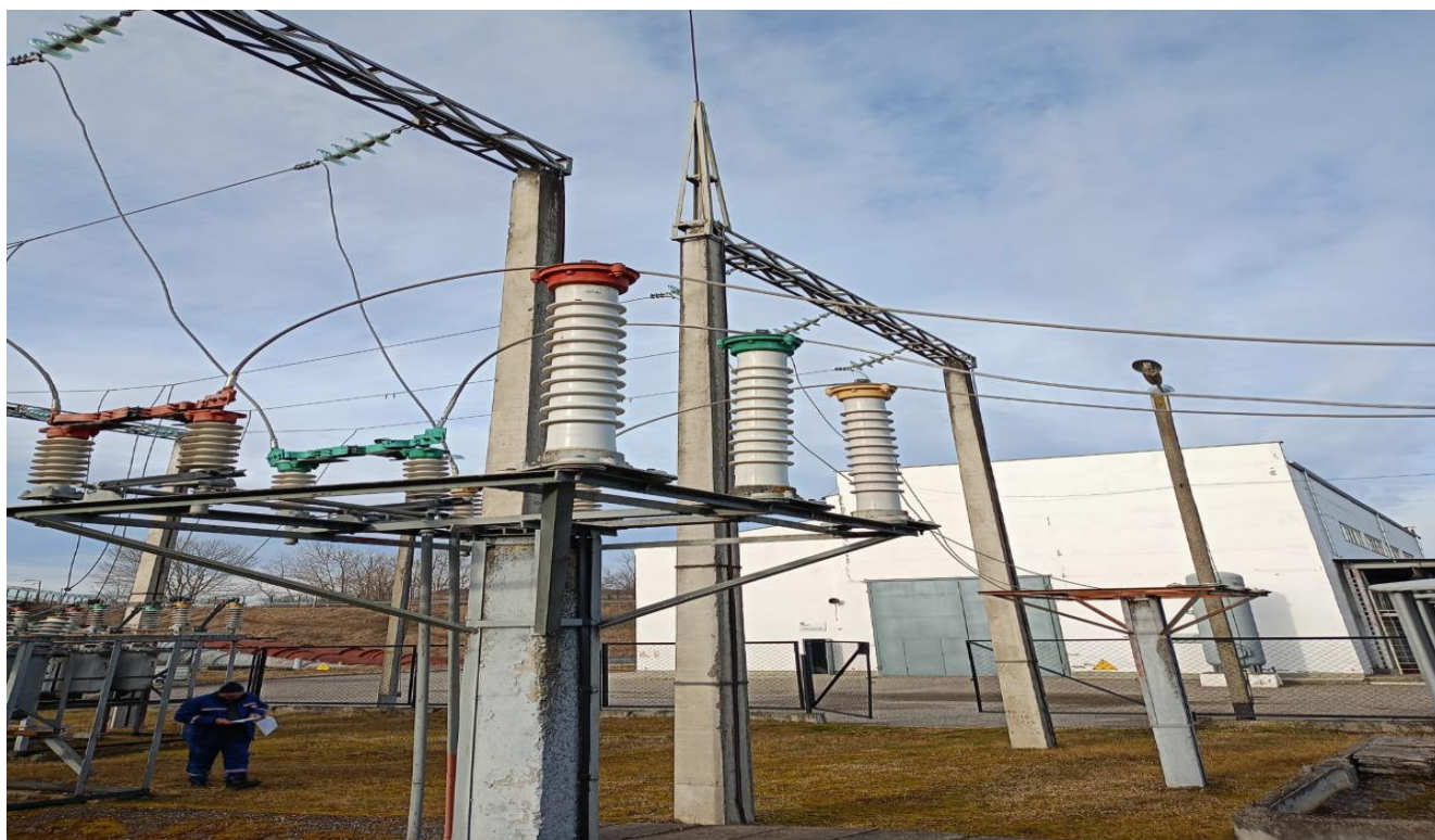
Разрядник РВС-35 ГЭС 3 РВ Т-33
