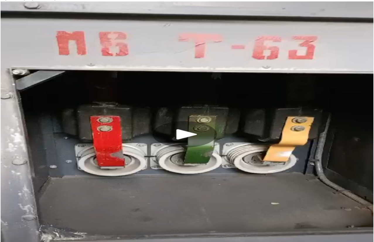
Трансформатор тока высоковольтный ТОЛ 10-1 Г-3 Фаза А ГЭС-3
