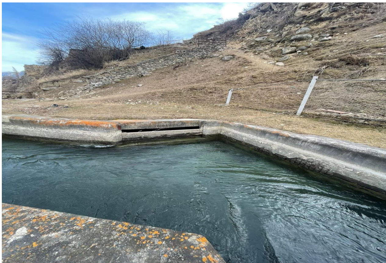
Затвор основной (рабочий) №2 промывника Мухольской ГЭС
