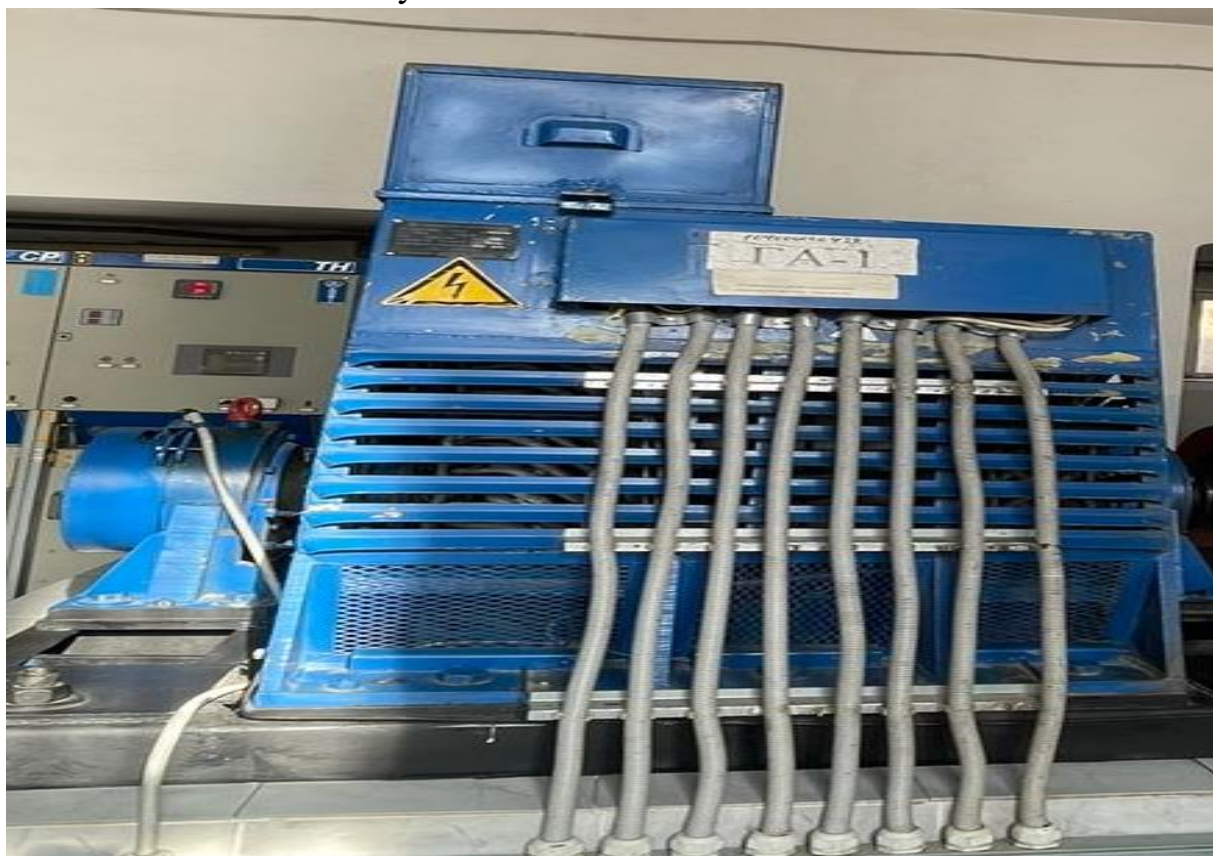
Гидрогенератор ГА №1 СГ-450-10В4 УХЛ4 с системой возбуждения СТС-1п-48-250 УХЛ4 Мух.ГЭС
