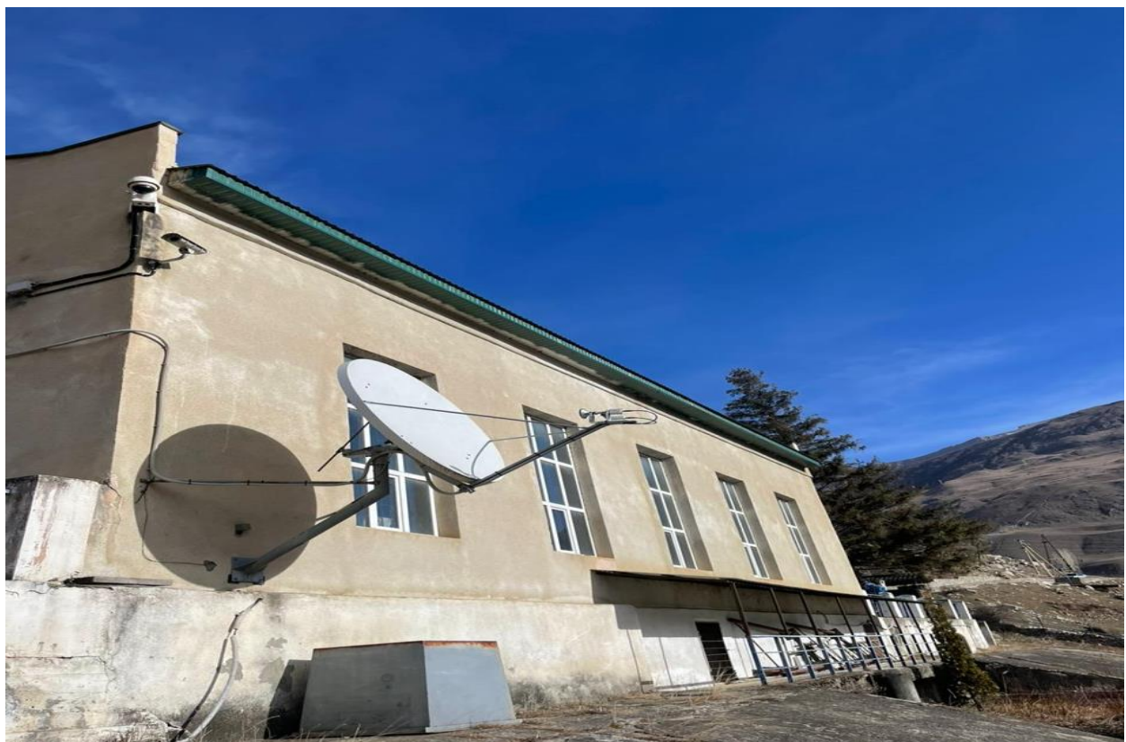
Оборудование резервного спутникового канала связи ЗССС Мухольской ГЭС
