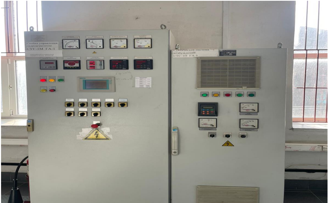
Система управления гидроагрегатом СУГ №1 МГЭС
