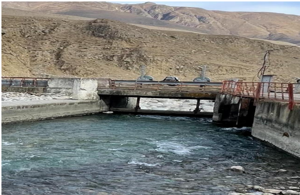
Затвор основной водосброса МГЭС
