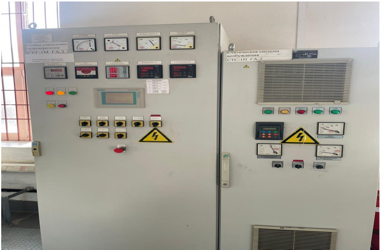
Система управления гидроагрегатом СУГ №2 МГЭС
