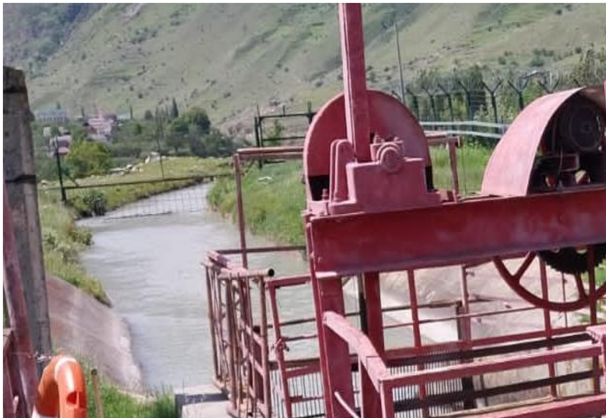
Подводящий канал МГЭС
