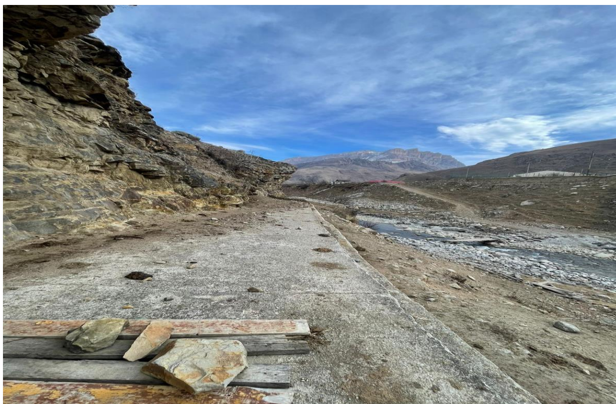
Деривационный канал МГЭС
