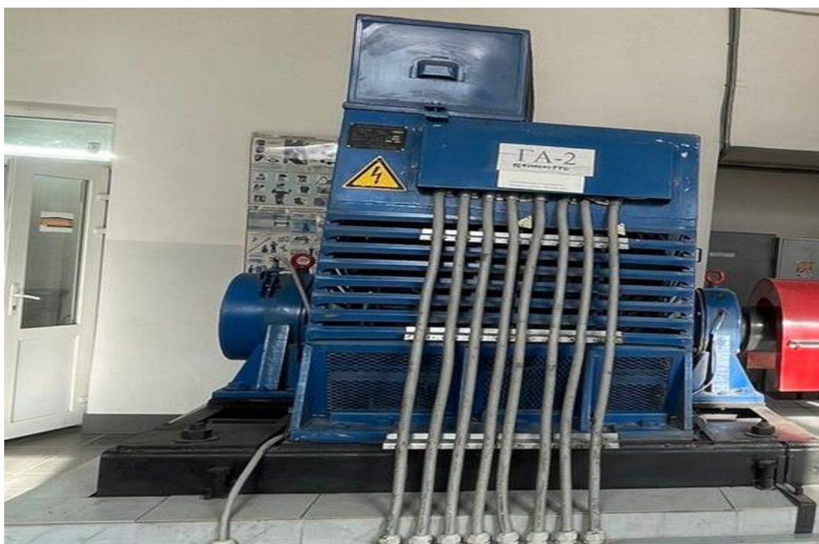
Гидрогенератор ГА №2 СГ-450-10В4 УХЛ4 с системой возбуждения СТС-1п-48-250 УХЛ4 Мух.ГЭС
