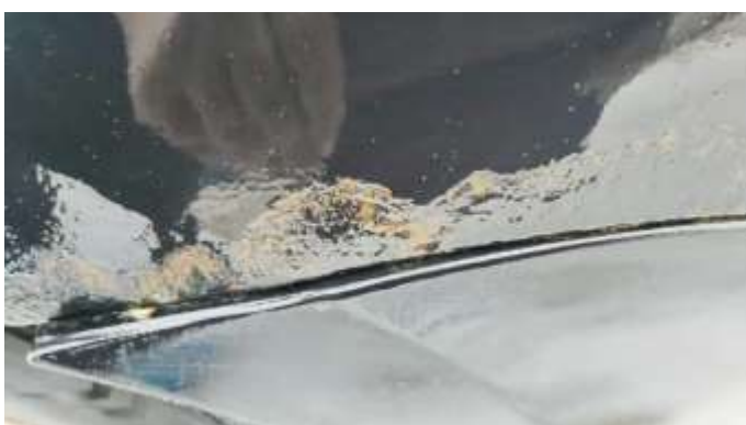
Фото №39. Дефекты эксплуатации
