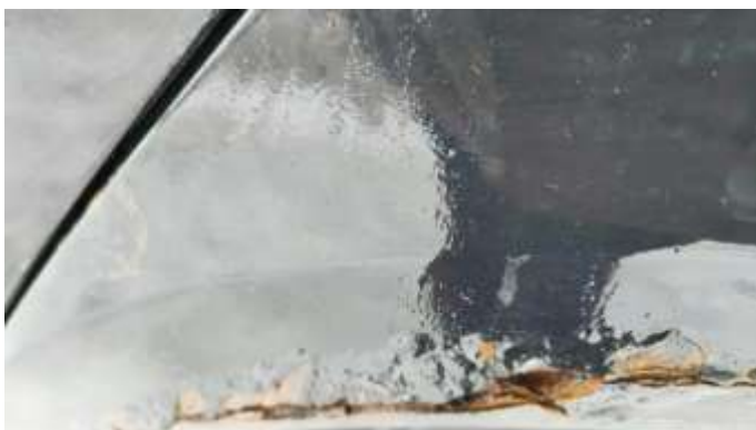
Фото №37. Дефекты эксплуатации
