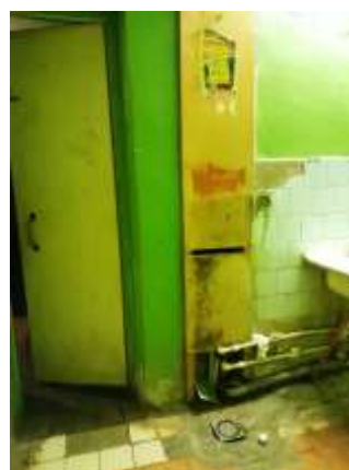
Фото №8. Места общего пользования
