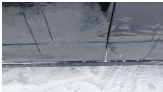
Фото №20. Дефекты эксплуатации
