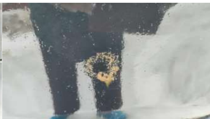
Фото №40. Дефекты эксплуатации
