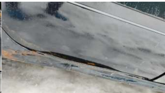
Фото №34. Дефекты эксплуатации
