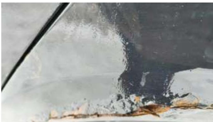
Фото №37. Дефекты эксплуатации
