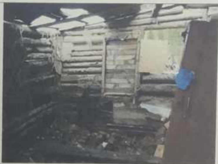
Веранда дома, кровля отсутствует, пол отсутствует
