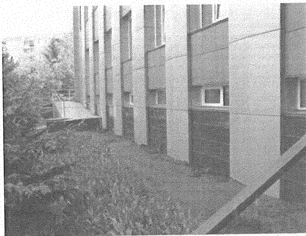
Рис.11. Фасад здания в осях АЛ/6-10. Отметкой пола помещений ниже планировочной отметки земли на 150мм. Первый этаж здания.
